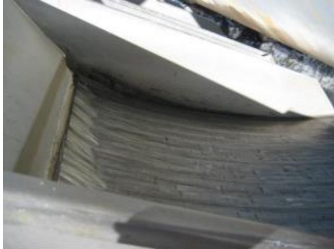
Rejillas de remoción de arena.
