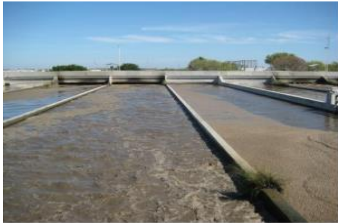
Zanjas de oxidación con y sin aireación.
