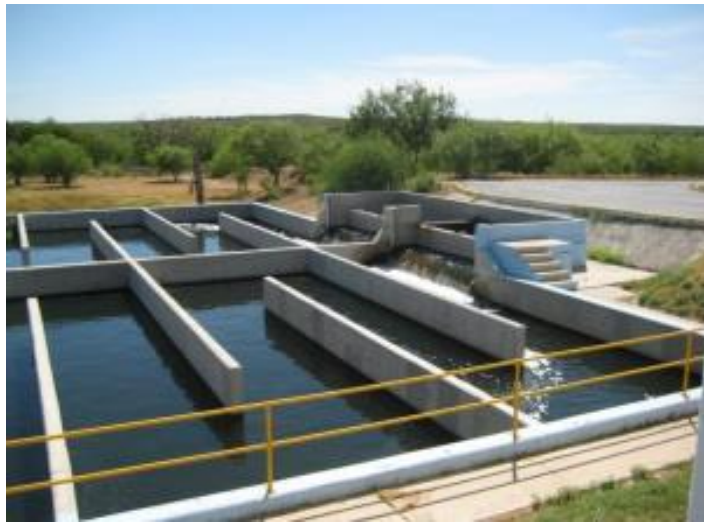
Tanque de contacto de cloro.
