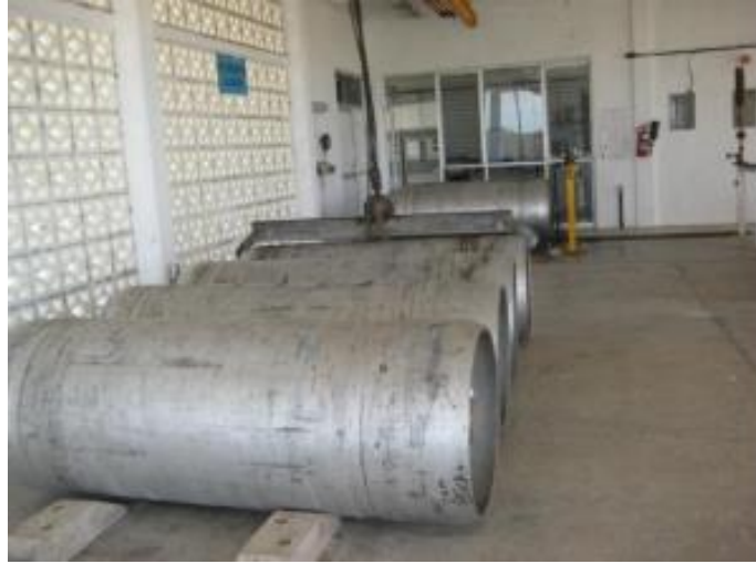
Estación de cloración.
