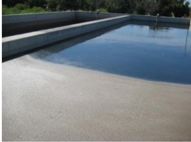
Digestión de Lodos en el tanque de retención de Lodos.
