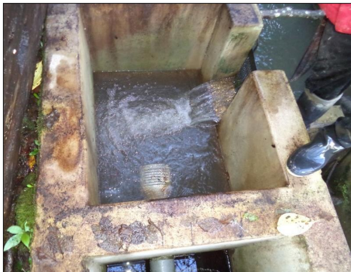
Fig. Captación de ladera
