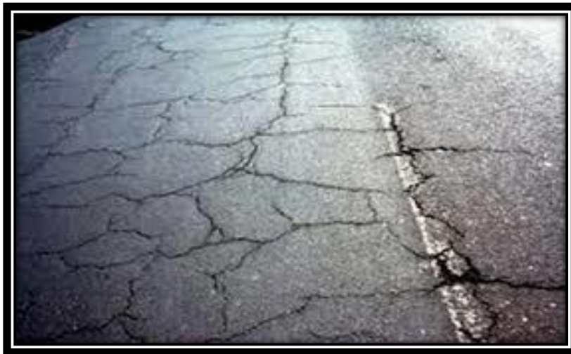
Imagen 6: Gravedad 2: Malla mediana (entre 0.30 y 0.5) sin o con material suelto
