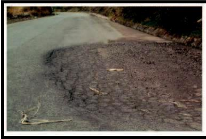
Imagen 15: Gravedad 3 – Profundidad > 4 cm
