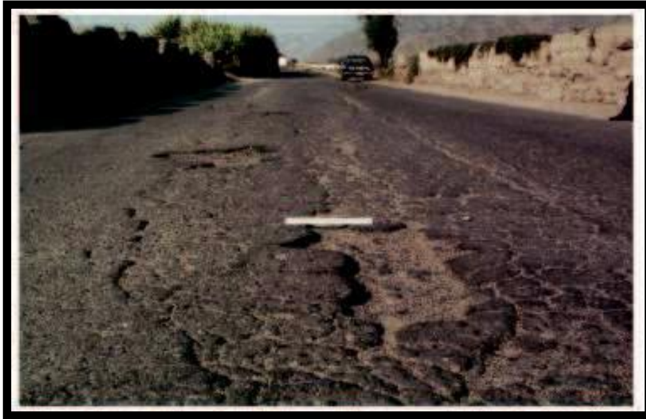
Imagen 36: BACHES (HUECOS) Gravedad 2: Diámetro entre 0.2 y 0.5 m
