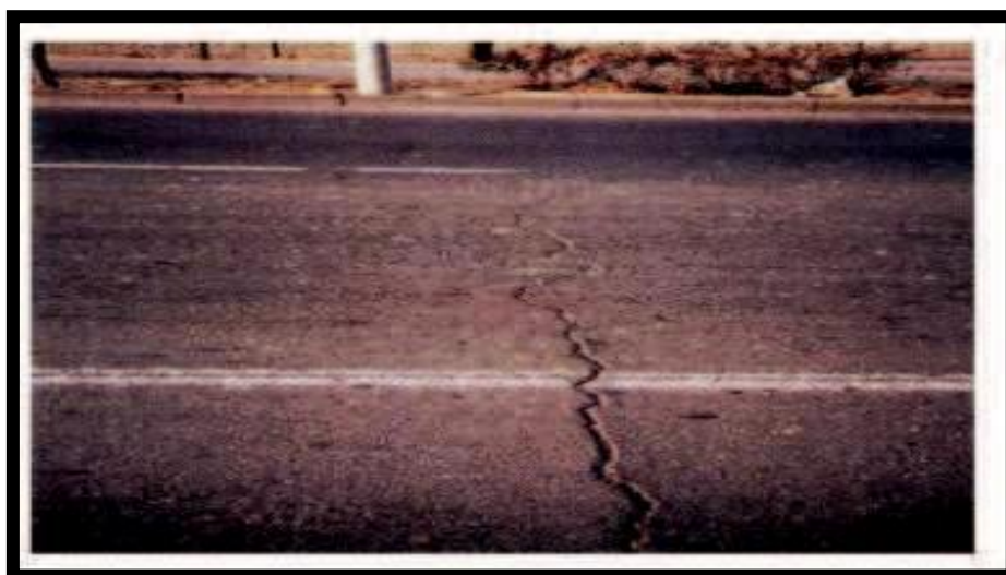
Figura 40: Gravedad 3: Fisuras gruesas corresponden a fisuras abiertas y/o ramificadas (ancho >3 mm). También denominadas grietas
