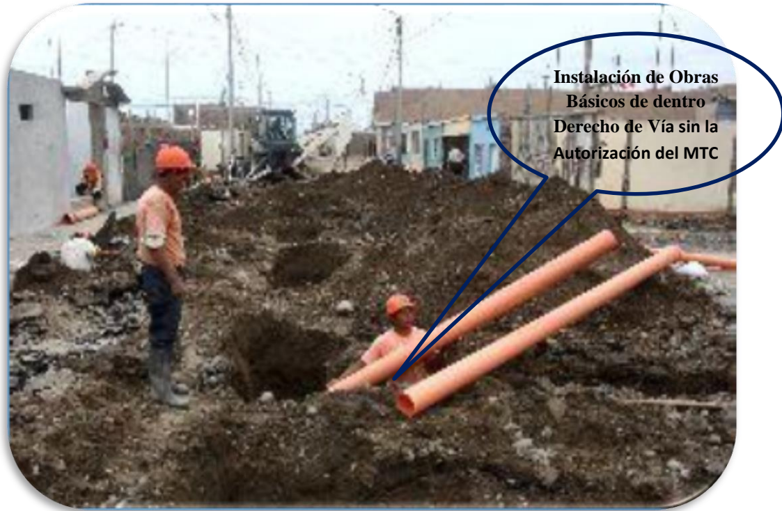
Figura N° 03: Invasión al Derecho de Vía con la Instalación de Servicios Básicos
