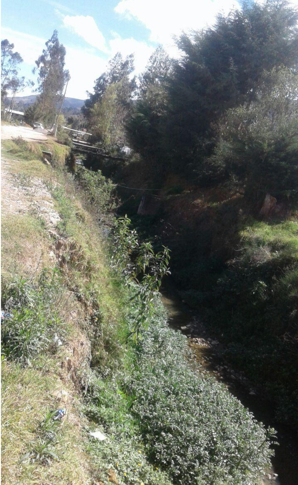
Fotografía N° 04: Cuadra N° 09 Jr. Pedro Ortiz Montoya, se aprecia erosión tanto en el margen izquierdo como derecho.
