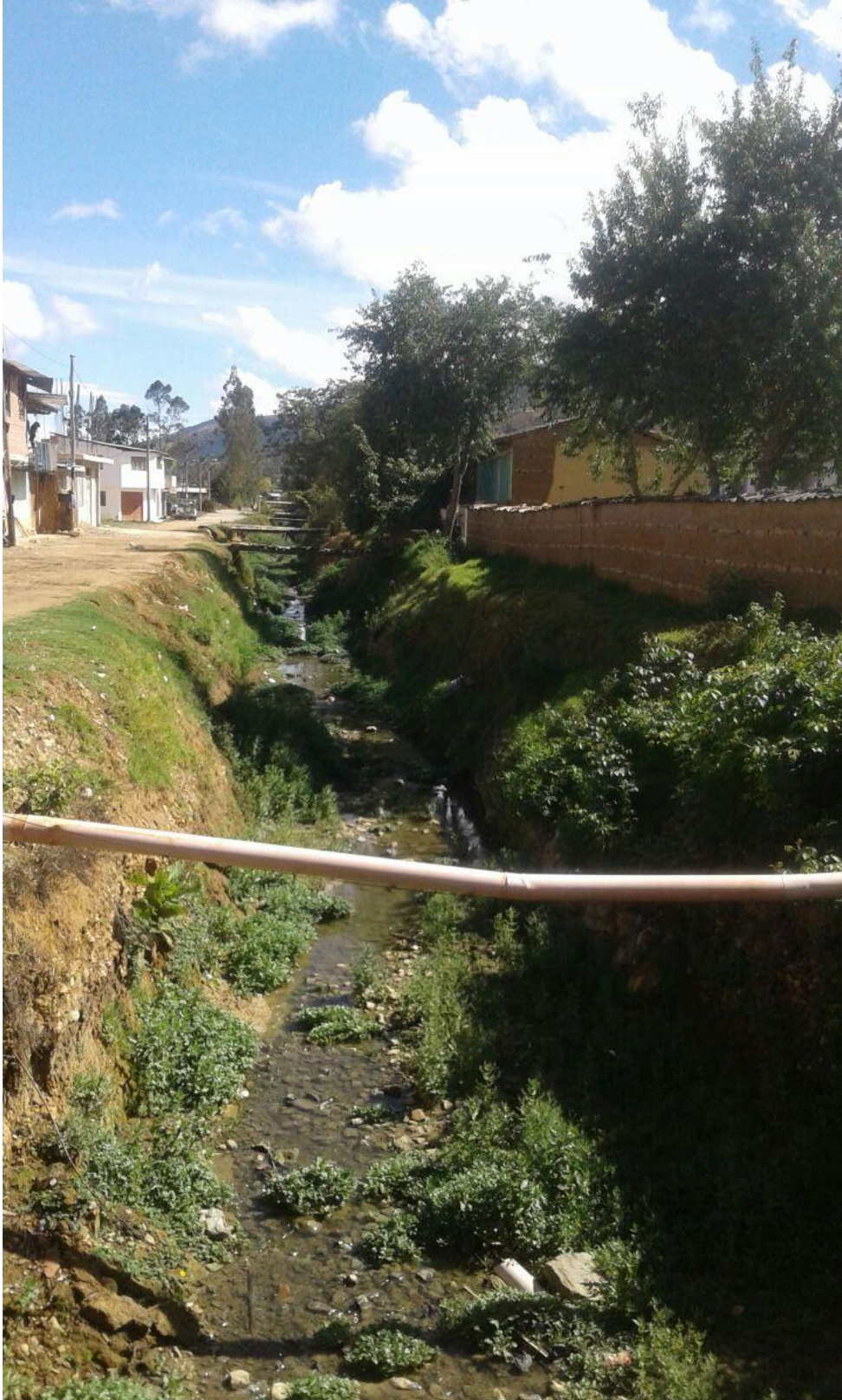
Fotografía N° 02: Cuadra N° 07 Jr. Pedro Ortiz Montoya, se aprecia mucha vegetación y erosión en el margen derecho casi ya llegando a las viviendas aledañas.
