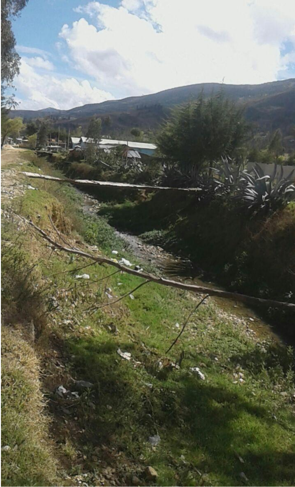
Fotografía N° 08: Cuadra N° 11 Jr. Pedro Ortiz Montoya, se aprecia erosión en el margen izquierdo del río y vegetación en el margen derecho.
