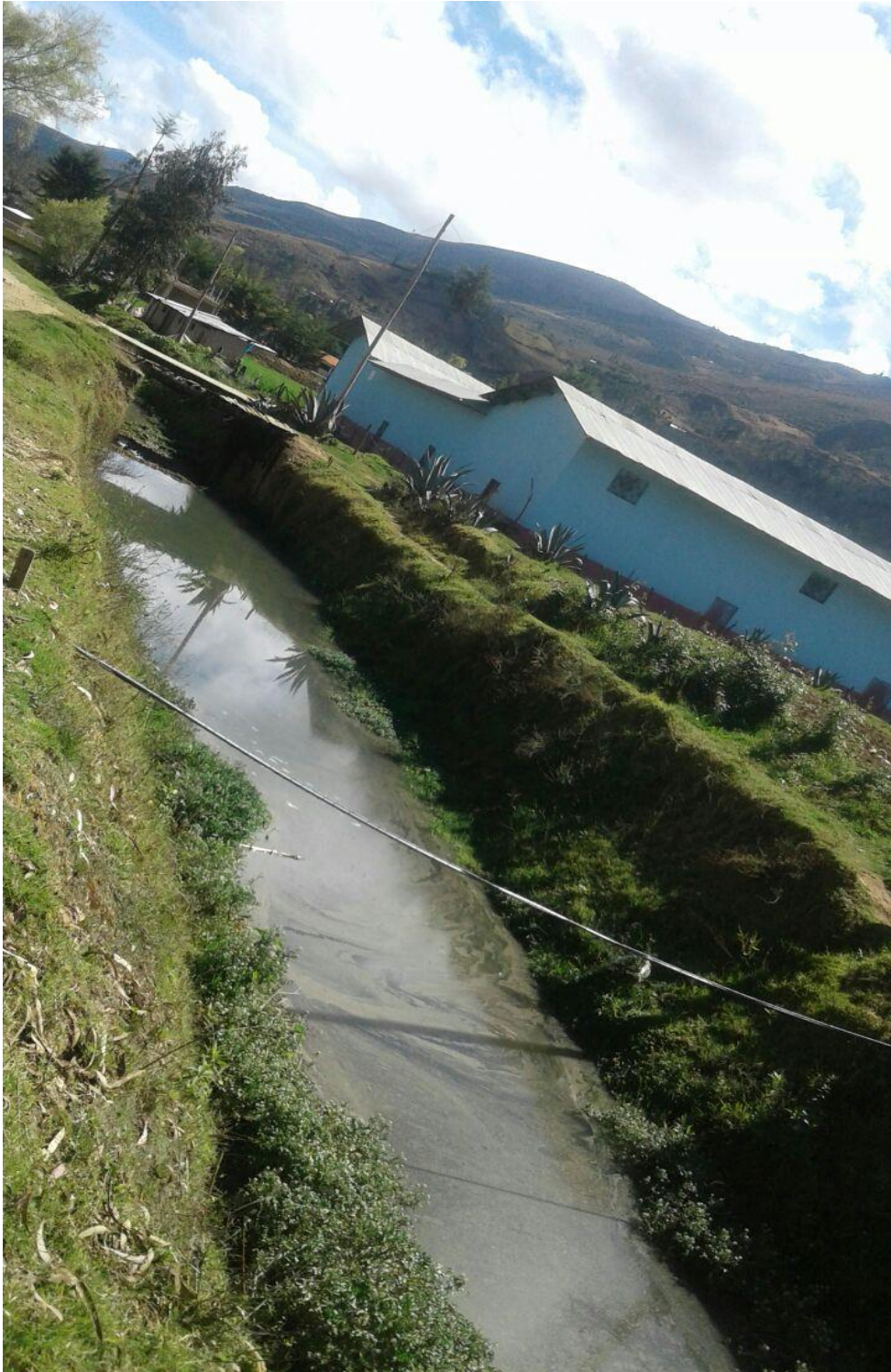
Fotografía N° 10: Cuadra N° 13 Jr. Pedro Ortiz Montoya, se puede apreciar estancamiento de agua.
