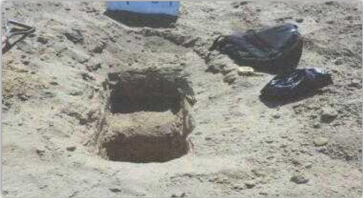
TOMA 05: EXCAVACION DE CALICATA N° 01 PARA EXTRAER MUESTRAS DEL ESTRADO. HERRAMIENTAS EMPLEADAS: PALANA TIPO CUCHARA + BOLSA HERMETICA.
