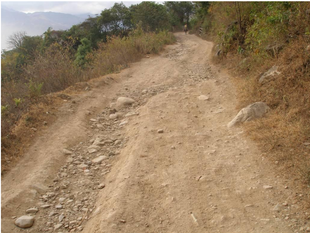
Foto N° 12:- Deterioro de la plataforma existe por la falta de cuneta lateral.
