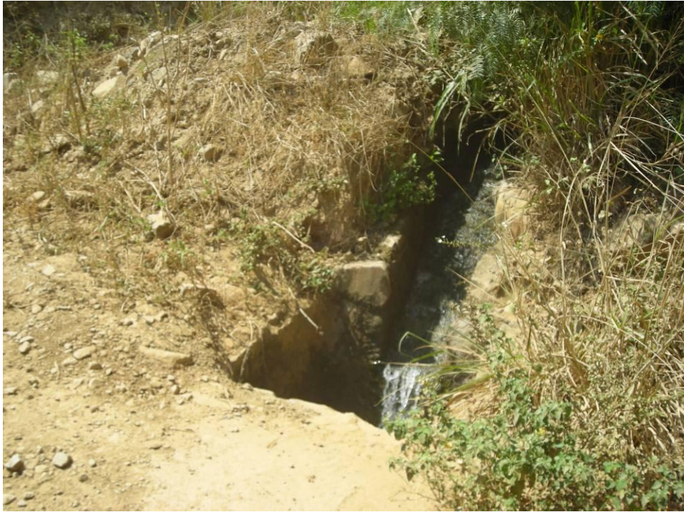
Foto N° 3:- Alcantarilla rustica existente en mal estado.
