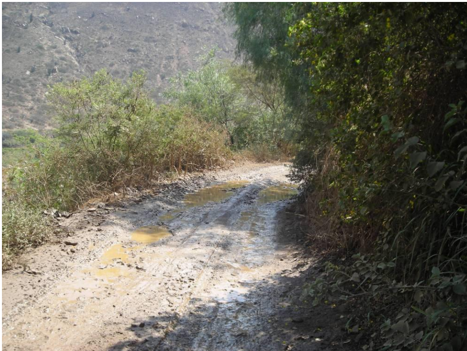
Foto N° 4:- Saturación de la plataforma por la falta de un buen sistema de drenaje.
