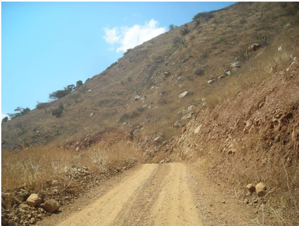
Foto N° 2:- Plataforma de rodadura existente sin cunetas y taludes altos.
