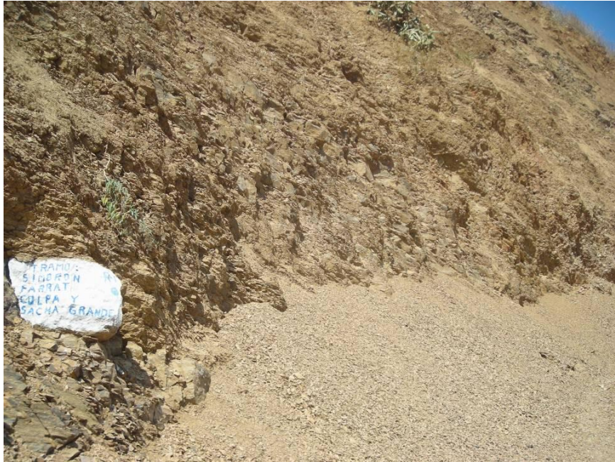
Foto N° 5:- Talud superior inestable con deslizamiento de material.
