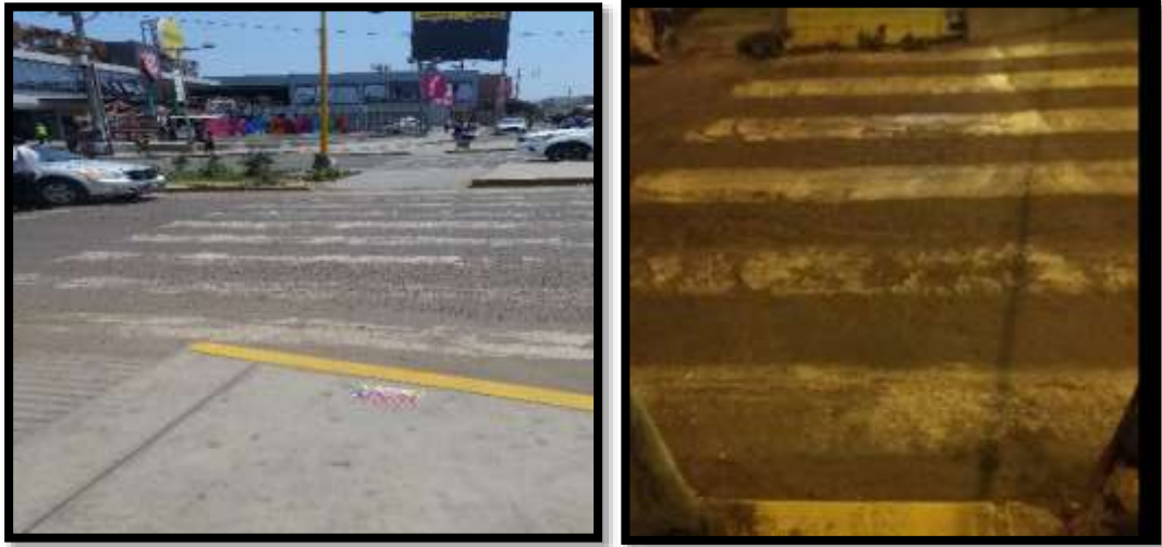
Figura 41 : Grupo de imágenes señalización horizontal
