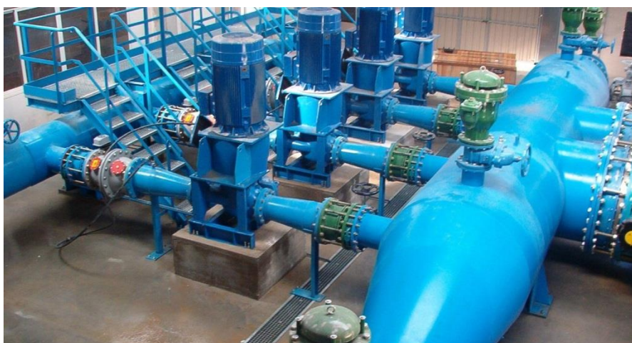
Fig. N° 10: Cuarto de Máquinas de centro de distribución de agua potable
