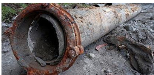
Fig. N° 4: Tuberías de Asbesto cemento deteriorada
