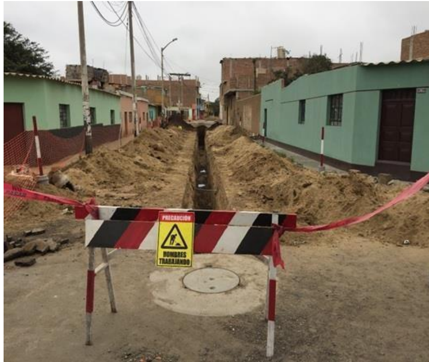
Fotografía N° 01 : Vista de la excavación para redes de alcantarillado en el Sector I . La Esperanza. Ejecución Consorcio La Esperanza. Supervisión Consorcio MBC.
