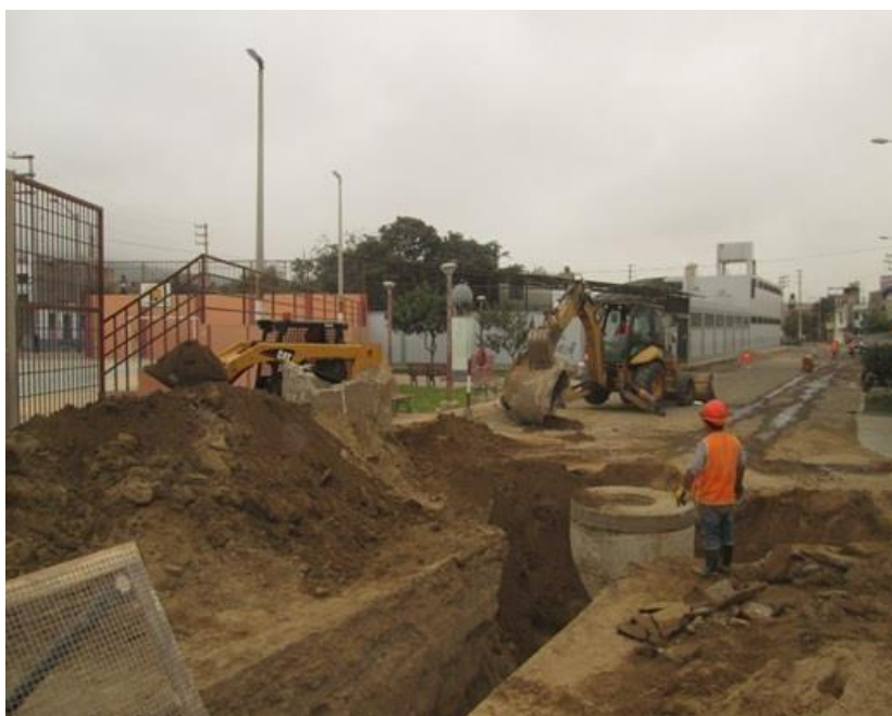
Fotografía N° 04 : Vista de la excavación para redes de alcantarillado en el Sector I. La Esperanza. Ejecución Consorcio La Esperanza. Supervisión Consorcio MBC.
