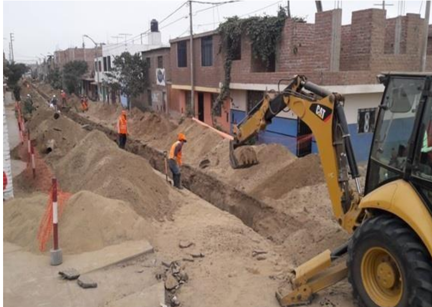
Fotografía N° 02 : Vista de la excavación para redes de alcantarillado en el Sector I . La Esperanza. Ejecución Consorcio La Esperanza. Supervisión Consorcio MBC.
