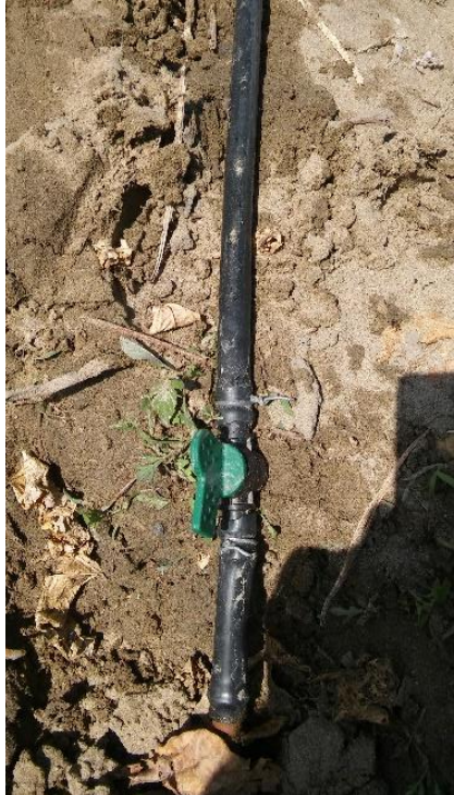
Figura 6. Nueva válvula de riego
