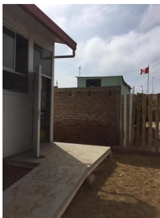
FOTOGRAFIA N°20: Ingreso a las aulas a través de una rampa metálica. Fuente: trabajo de campo.
