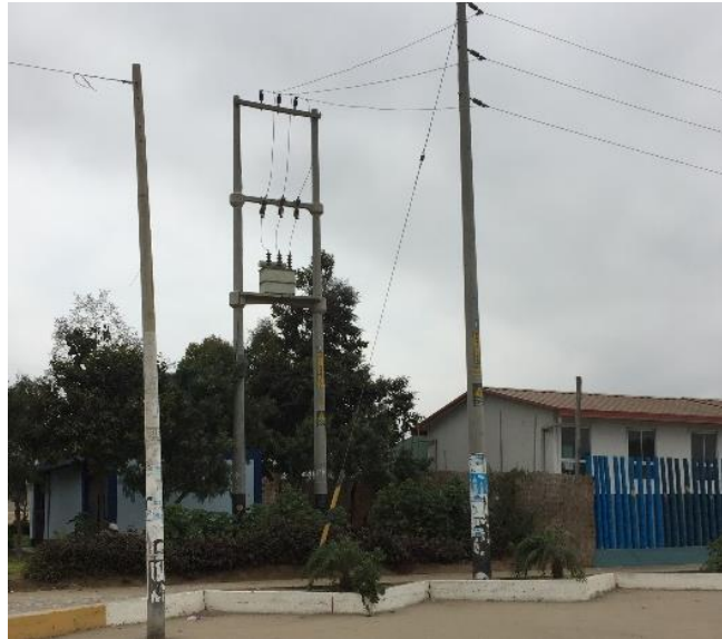
FOTOGRAFÍA N° 39: Sub estación aérea Fuente: trabajo de campo
