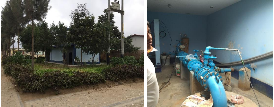
FOTOGRAFÍA N° 34 y 35: Electrobomba Fuente: trabajo de campo
