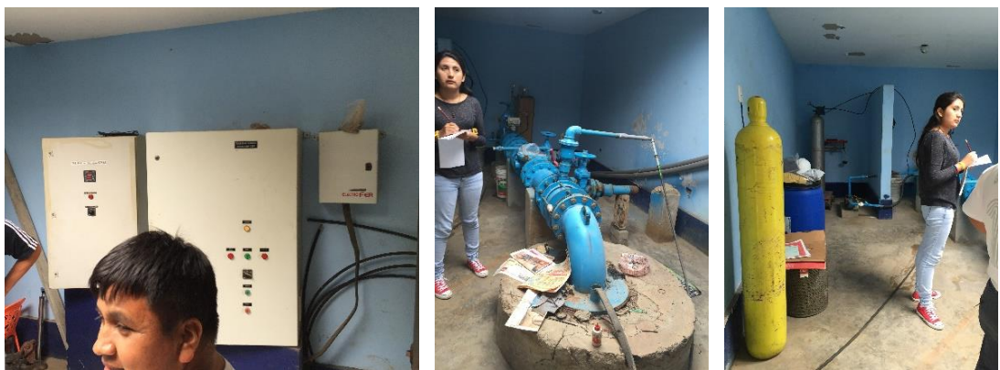
FOTOGRAFÍA N° 36, 37 y 38: Electrobomba Fuente: trabajo de campo
