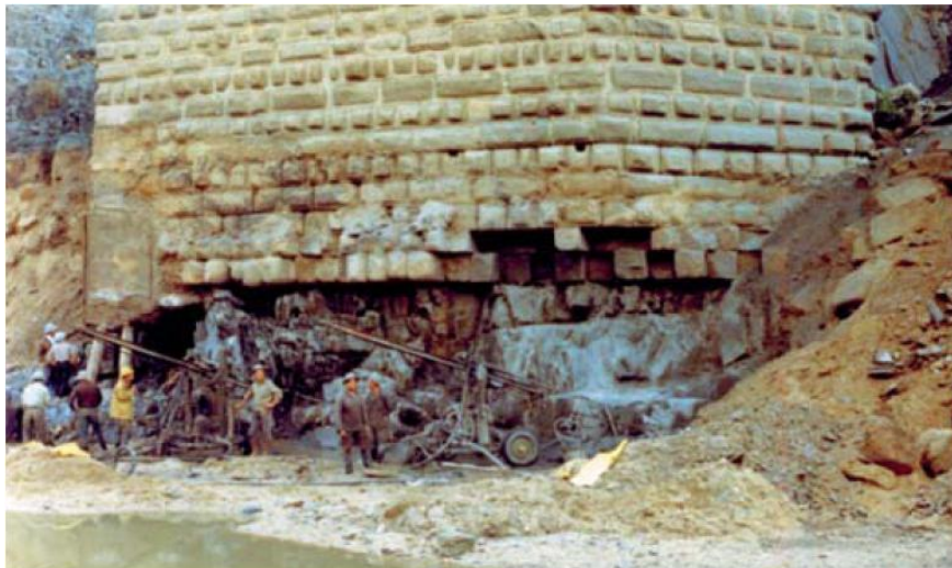
FIGURA 3- Erosión y socavación en Pilares - Puente Alcántara.
