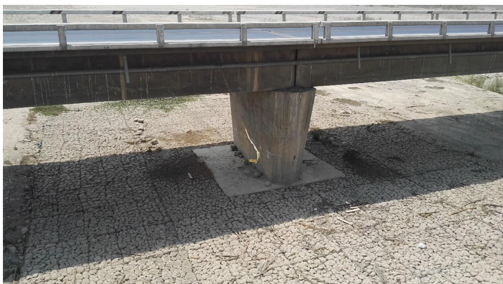
Figura 3. Gaviones protegiendo al pilar antes del fenómeno del niño 2017
