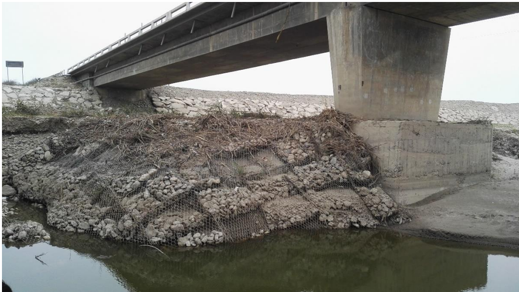
Figura 2. Erosión en el pilar y deterioro del gavión producido por el caudal del río.
