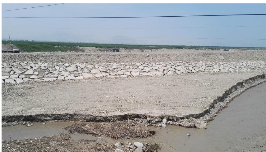
Figura 1. Erosión del cauce en el río Chicama
