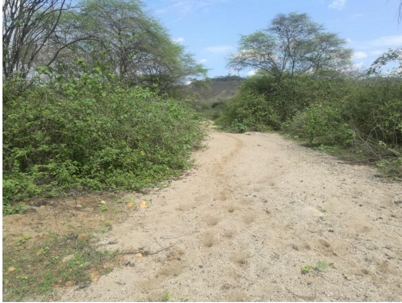
Fotografía N°6: Pérdida de sección vial.
