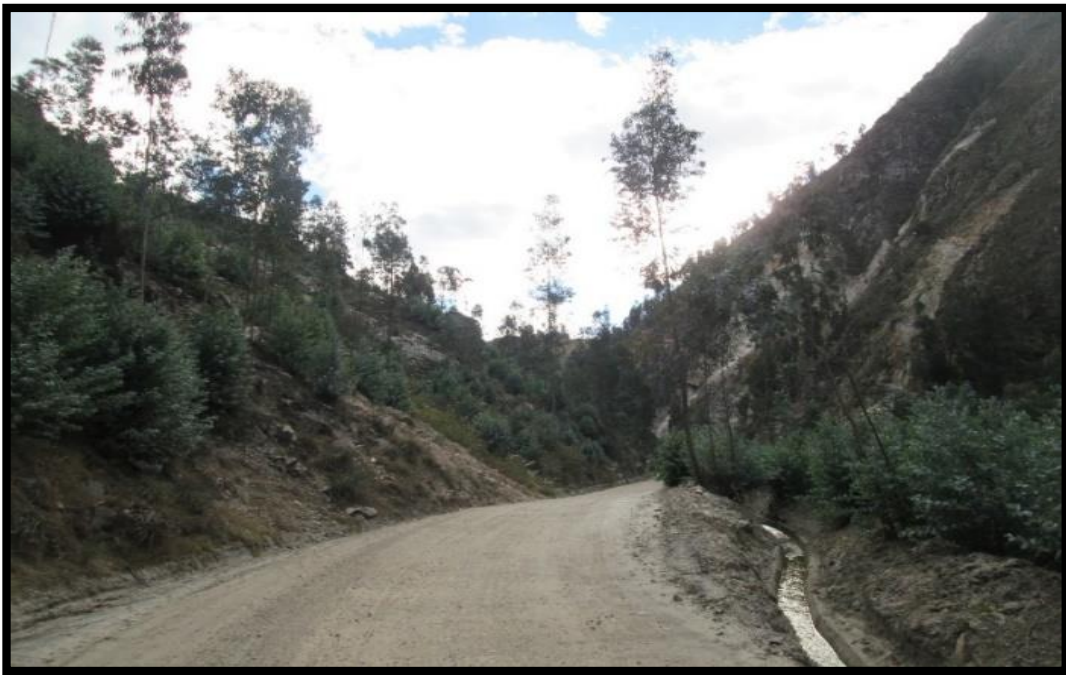
Fotografía 15: Vista de la situación actual de la carretera hacia Sanagoran
