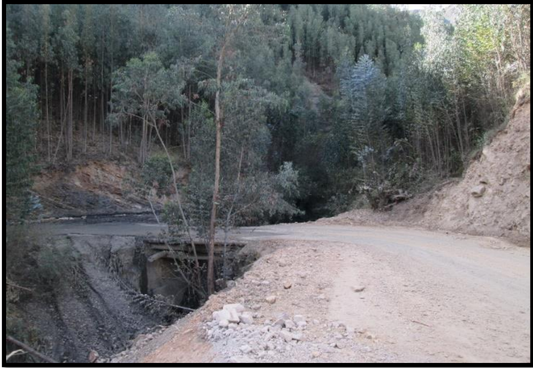
Fotografía 15: Vista de la situación actual de la carretera hacia Sanagoran
