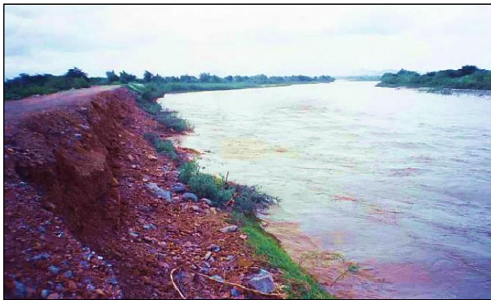
Fig. 30 Falla de una defensa ribereña de tierra sin protección Fuente: internet
