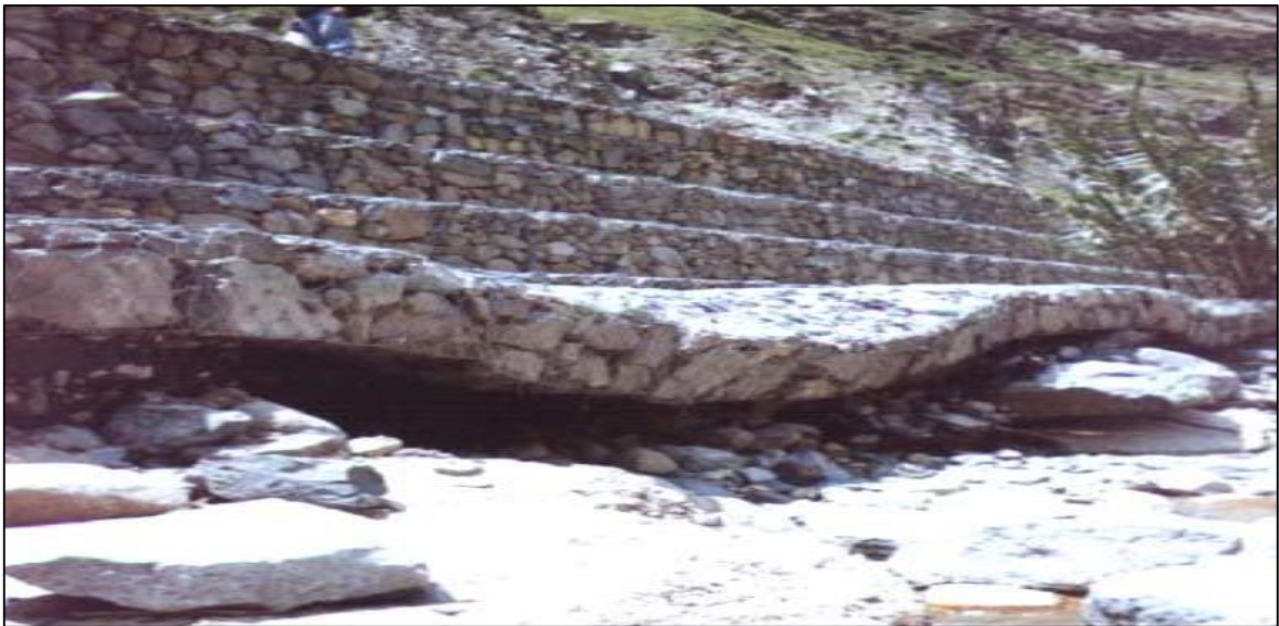
Fig. 43 Socavación local en gaviones colocados en las márgenes del RÍO CHILLÓN, para proteger la carretera a CANTA Km 83, en 1998 Fuente: internet
