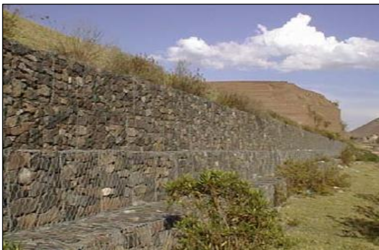
Fig. 55 Aplicaciones de gaviones – Defensa Ribereña Río Huatanay (CUSCO) Fuente: Maccaferri
