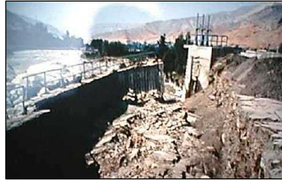
Fig. 28 Inundación San Diego y Río Chillón – Lima 2001 Fuente: internet
