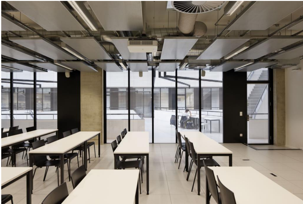
Fotografía Aula Pabellón Mecánica (Redes expuestas), EPFL
