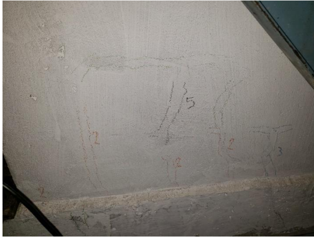
Foto N°74: Fisuras verticales en la fase 2
