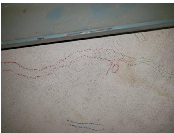
Foto N°60: Fisura diagonal en la albañilería
