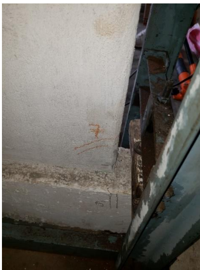
Foto N°58: Fisura en el talón de la columna
