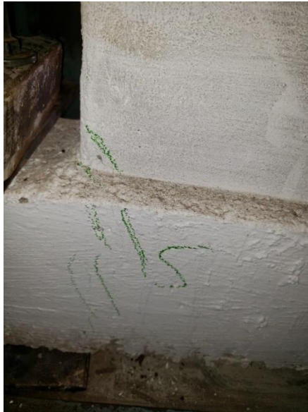
Foto N°55: Fisura en la cimentación
