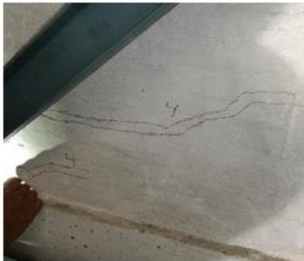
Foto N°14: Primera fisura diagonal fase 4
