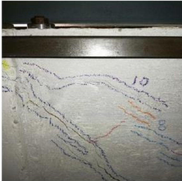
Foto N°20: Muro agrietado fase 10
