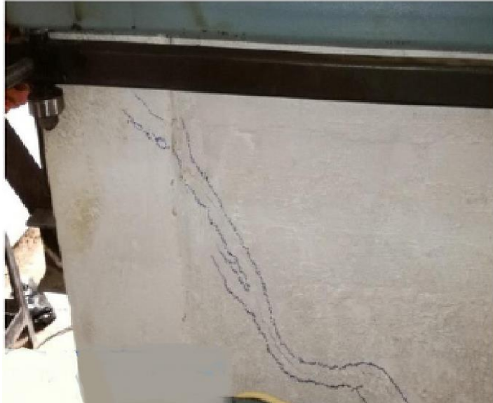
Foto N°15: Fisura diagonal fase 5
