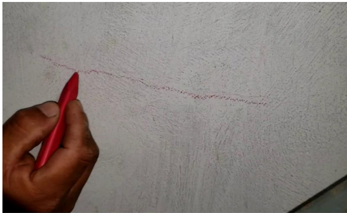
Foto N°53: Una posible fisura
