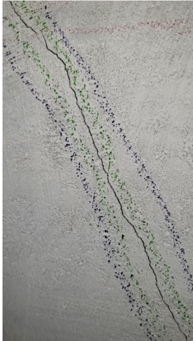
Foto N°63: Fisura diagonal última fase
