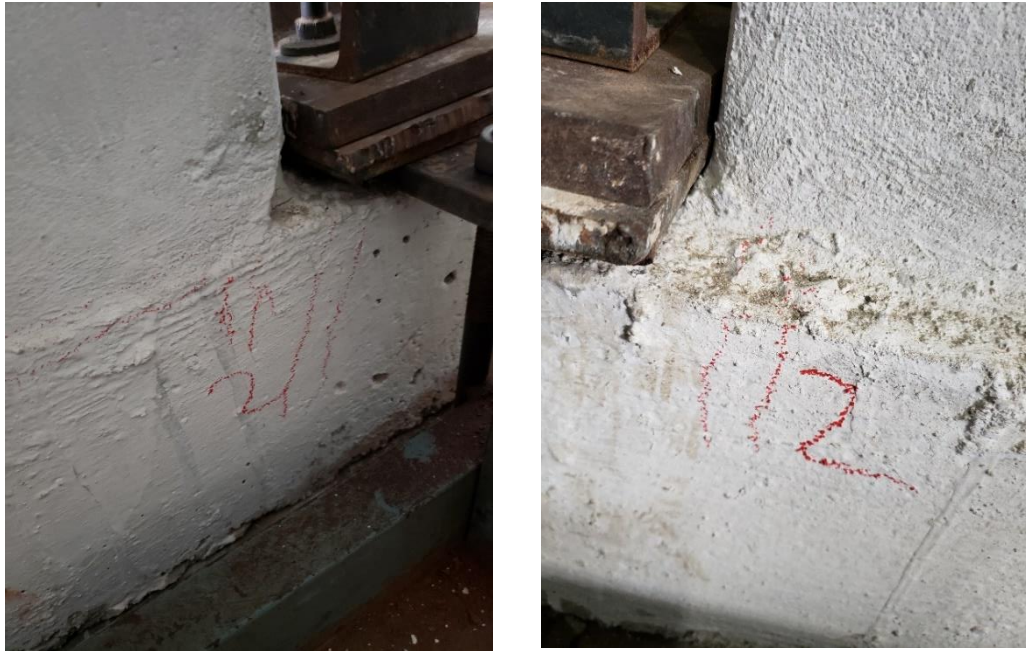
Foto N°65 y N°66: Primera fisura en la viga de cimentación
