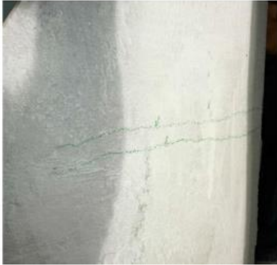
Foto N°13: Falla de tracción por flexión en la columna fase 3
