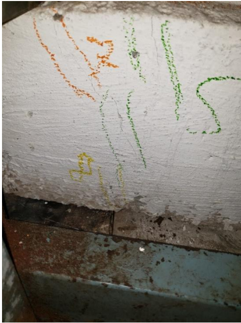
Foto N°59: Fisura en la cimentación
