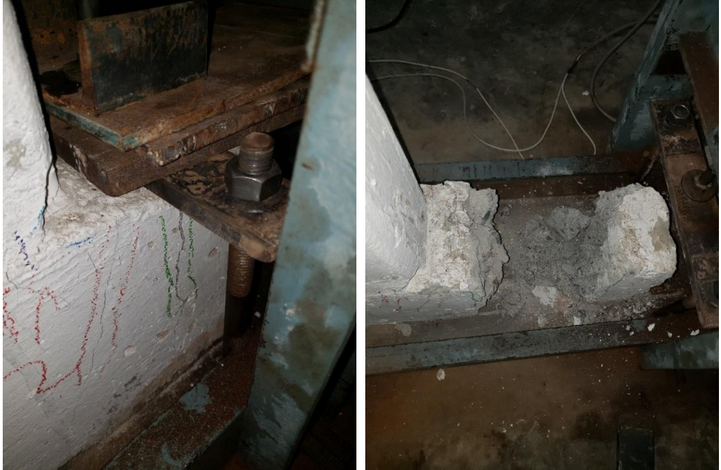
Foto N°71 y N°72: Rotura de la viga de cimentación
