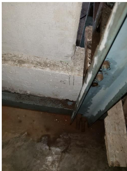
Foto N°56: Fisura en la cimentación
