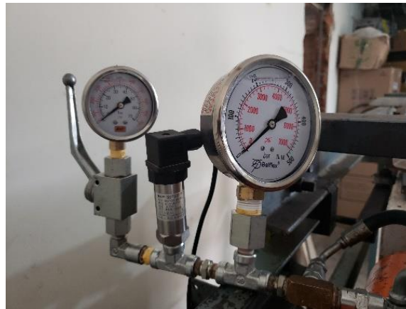
Foto N°42: Manómetros y sensor de presión
