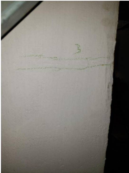
Foto N°67: Primera fisura en la columna
