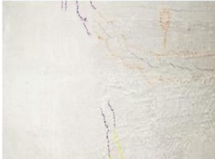
Foto N°10: Fisura en la fase 9
