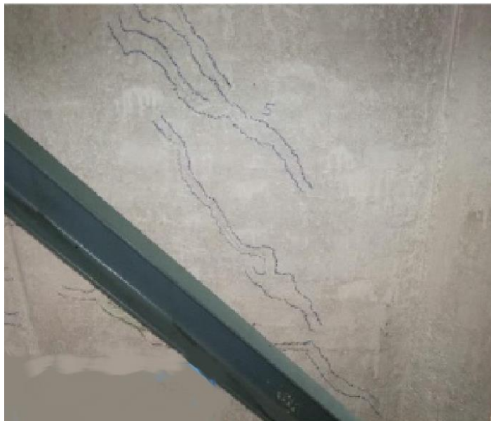
Foto N°16: Falla por corte fase 5
