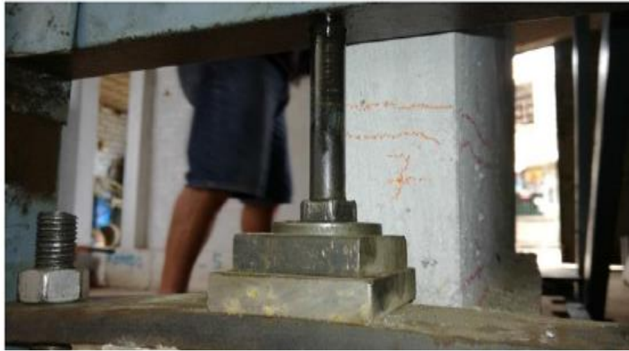
Foto N°08: Fisura en la fase 7
