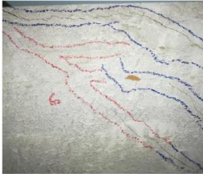
Foto N°17: Degradación de la albañilería fase 6
