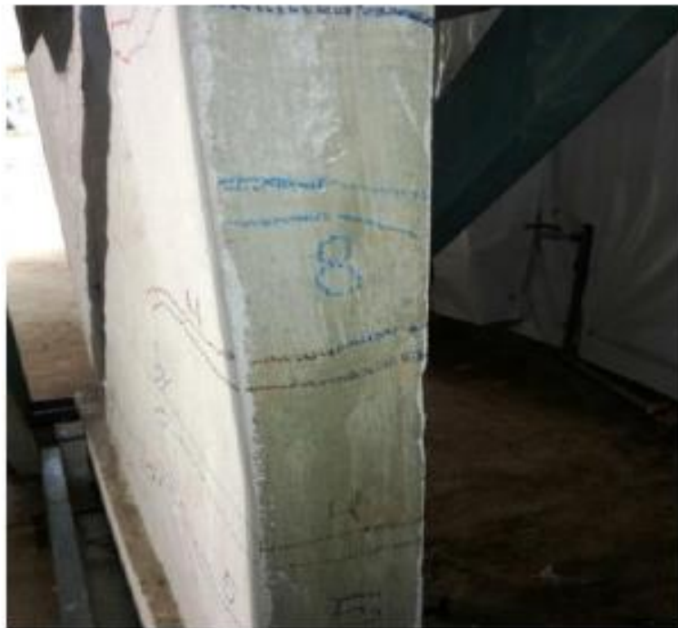
Foto N°19: falla de tracción por flexión fase 8 Fuente: Ref. N°07
