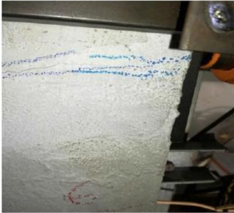
Foto N°18: Falla en la zona de contacto muro-pistón de la gata hidráulica fase 8 Fuente: Ref. N°07
