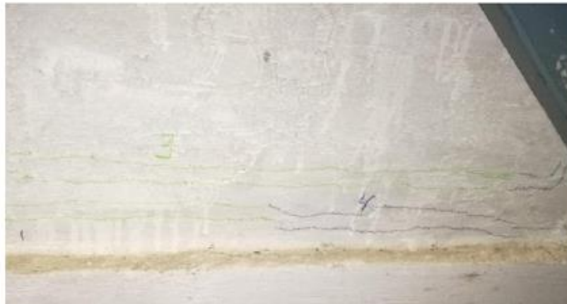
Foto N°07: Fisura en la fase 4
