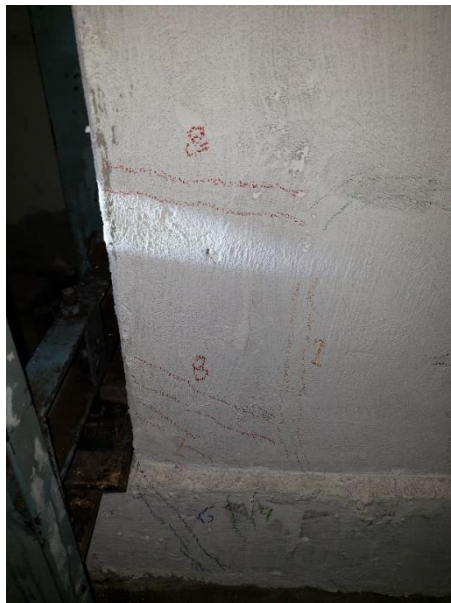
Foto N°80: Fisuras por falla de tracción por flexión
