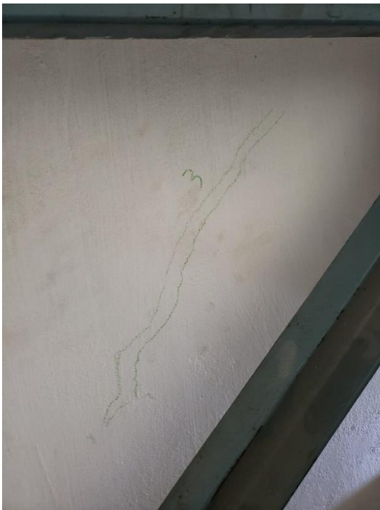
Foto N°68: Primera fisura en la albañilería
