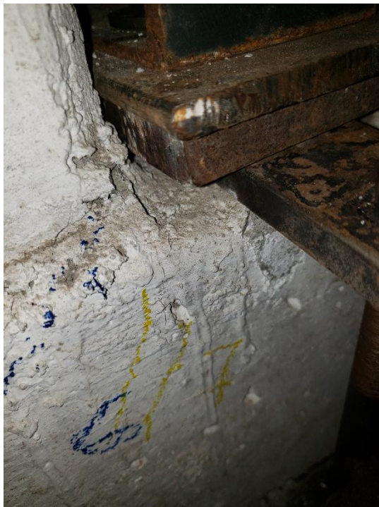
Foto N°78: Fisura en la viga de cimentación
