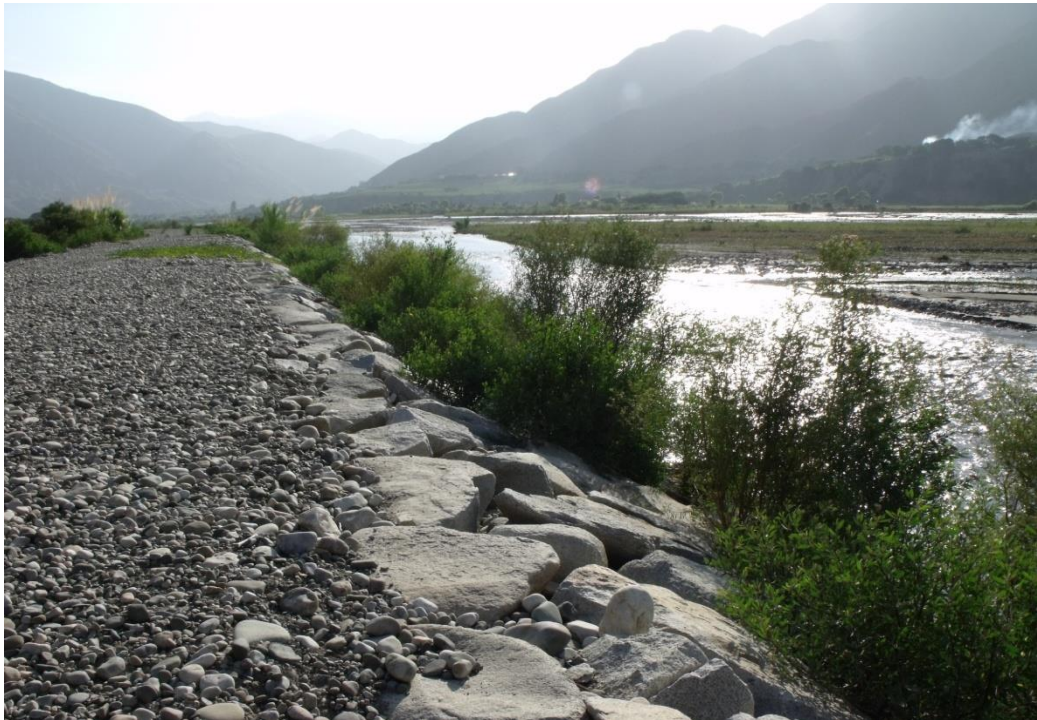
Figura 3-6. Dique existente de material homogéneo (Construido por el PERPEC en el 2006), protegido por enrocados extraídos de la cantera propuesta para el presente estudio (Quebrada El Limo) con buenos resultados
