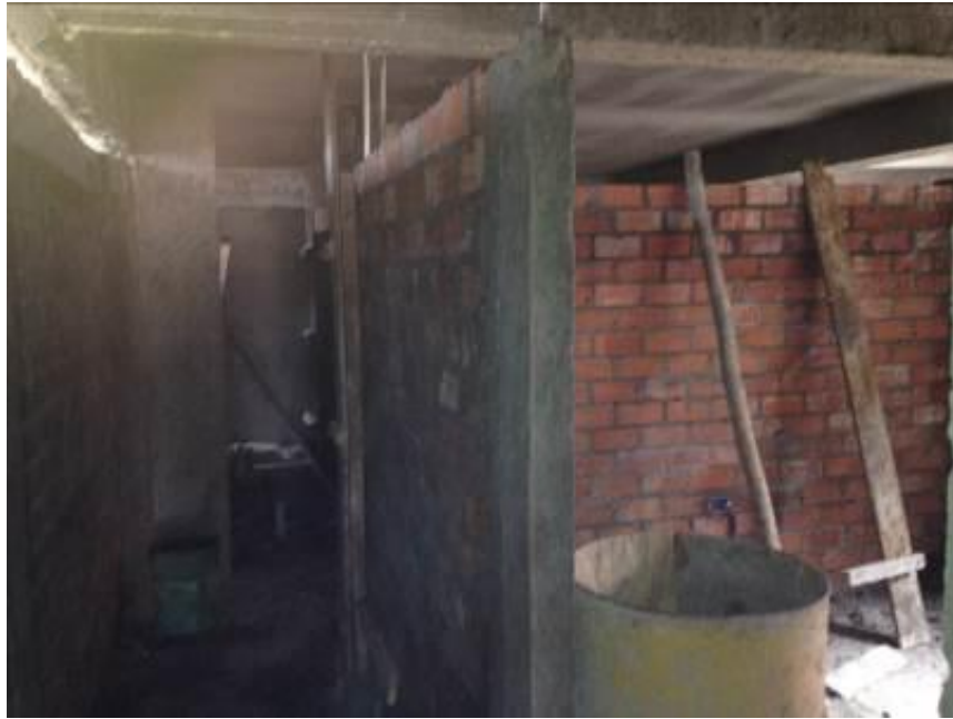
Se observa avance en tabiquería en el 2do nivel del Bloque B.
