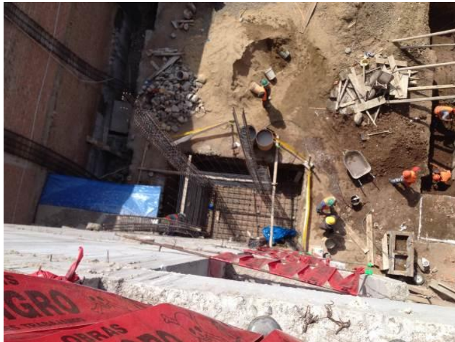
Se observa vista externa de avance en excavaciones, subcimiento y armado de zapatas y placas del Bloque A.
