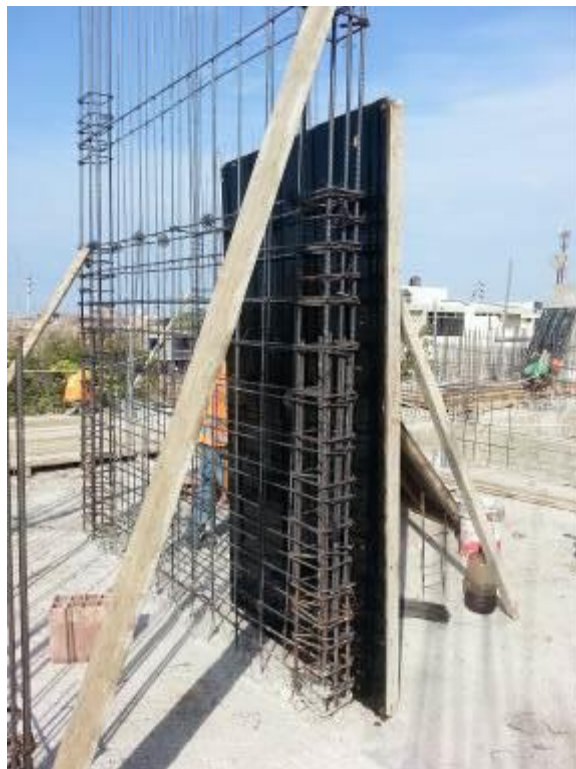
Se observa proceso de encofrado y desencofrado de Placas 3er nivel – Bloque B.
