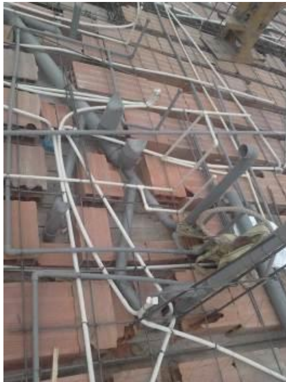
Se observa instalaciones eléctricas y sanitarias.
