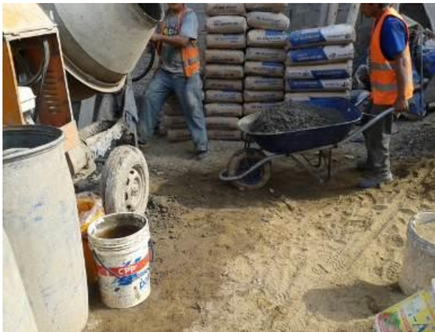
Se observa el material empleado para el colado de concreto de zapatas, vigas de cimentación, columnas y placas del 1er nivel. Se empleó cemento MS.
