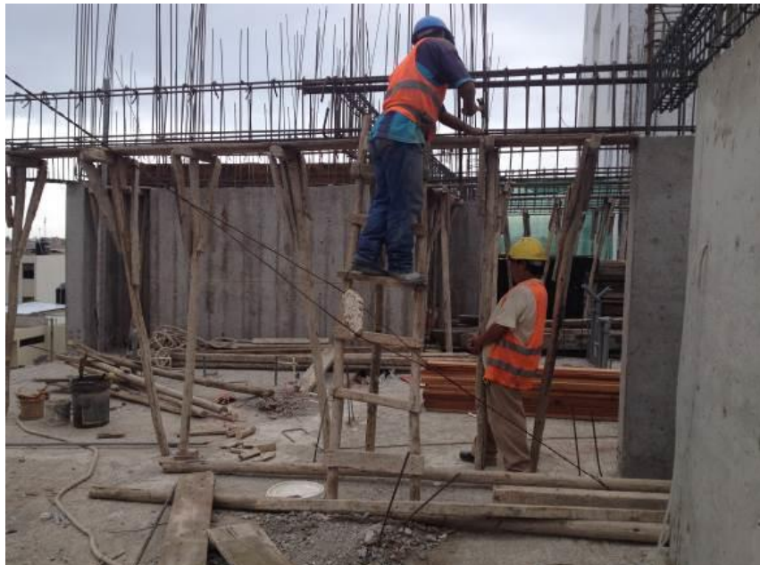
Se observa encofrado de fondo de viga de la losa del 7mo nivel - Bloque B.
