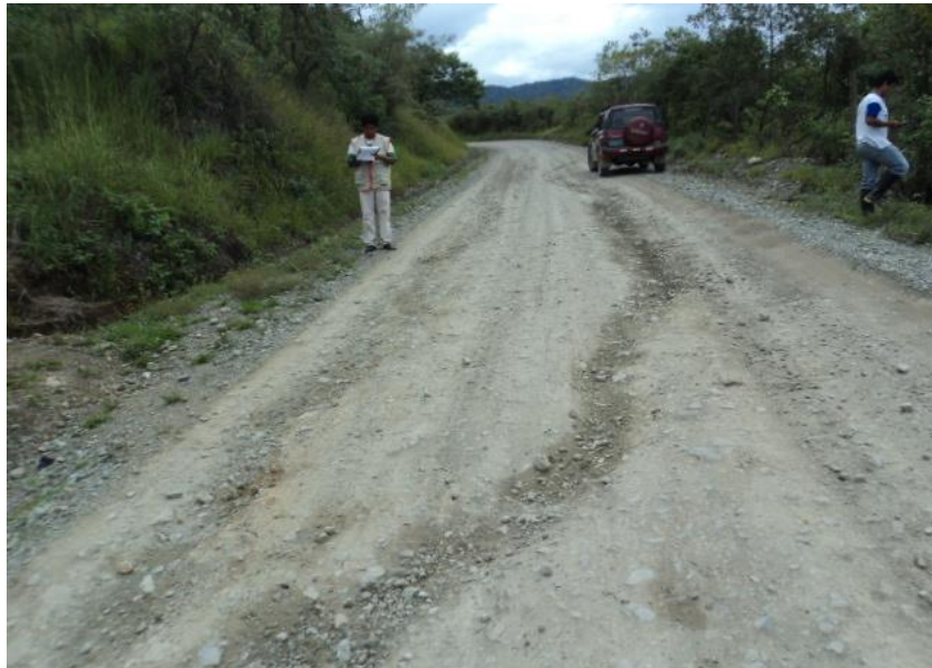
Fotografía N°4: Estado actual en el Km. 14+640. Erosión.
