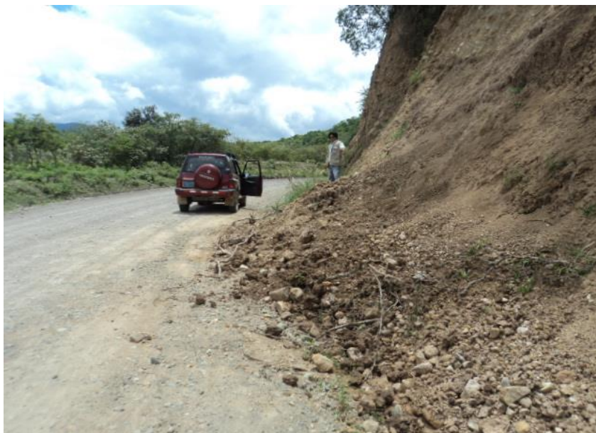
Fotografía N°6: Zona De Riesgo Posibles Derrumbes Km 5+100
