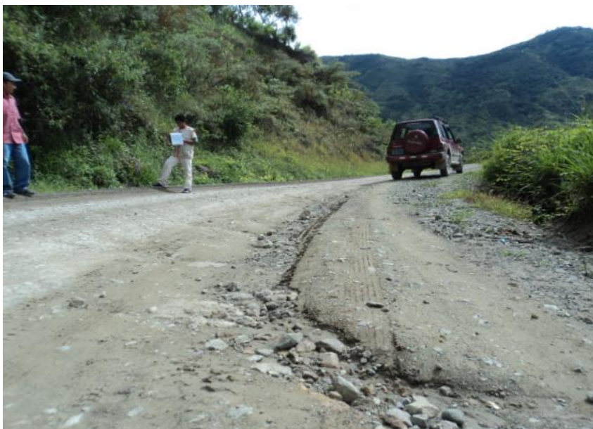
Fotografía N°5: Estado actual en el Km. 18+300. Erosión.
