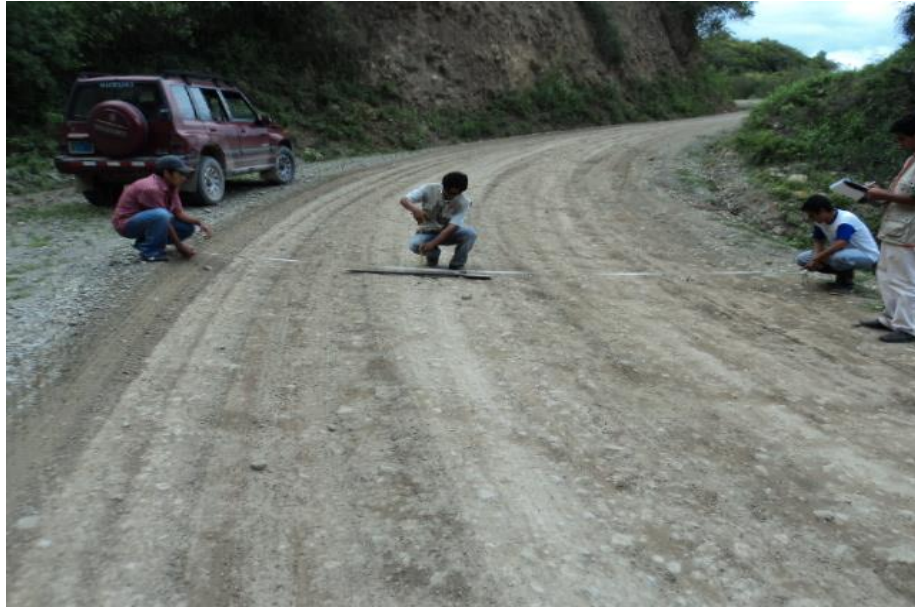
Fotografía 3: Estado actual en el Km. 09+400. Deformación.
