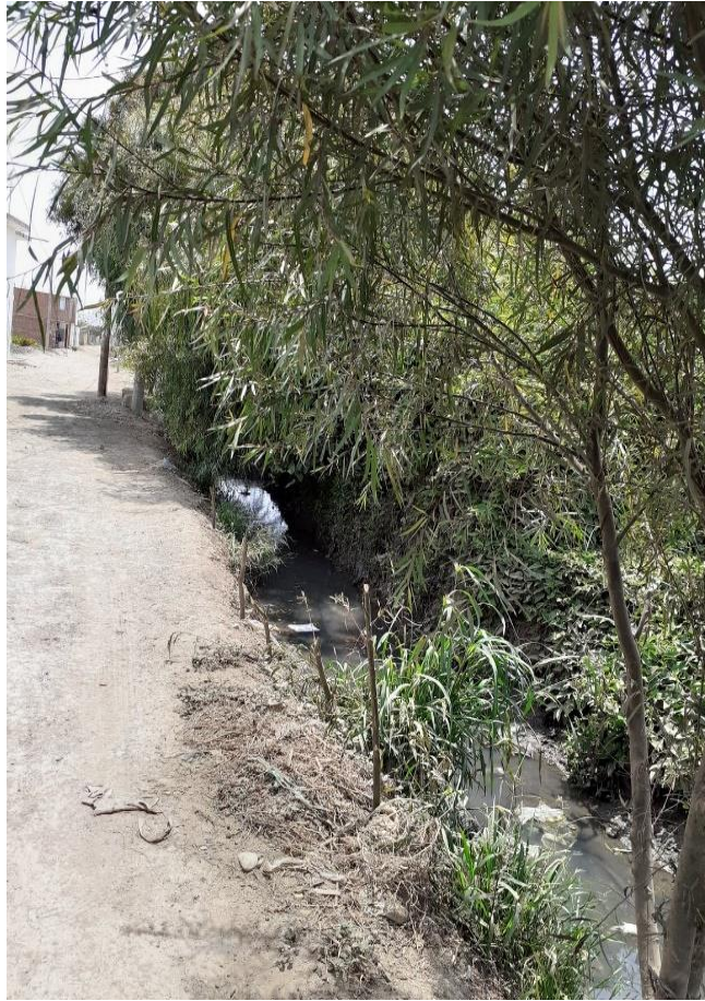
Foto N° 3: acumulación de basura y vegetación.
