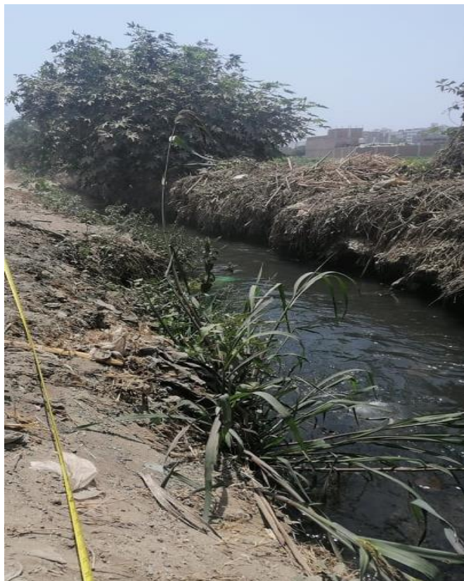
Foto N° 2: canal en mal estado.
