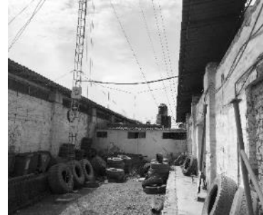
Paredes laterales en mal estado estructural
