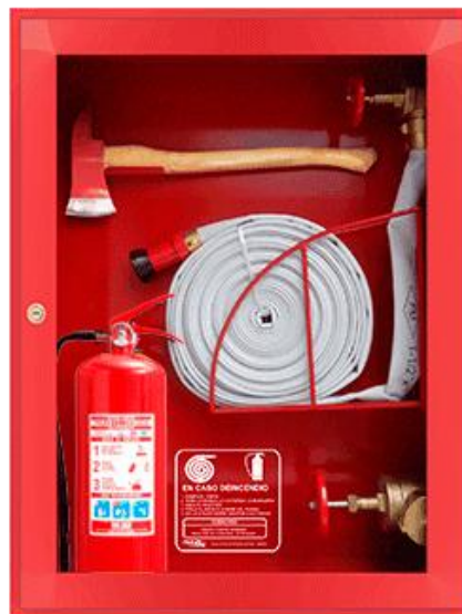
Ilustración 50: Gabinete contra incendios
