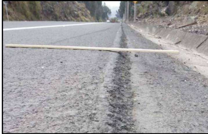
Figura 14: Falla de Desnivel Carril / Berma
