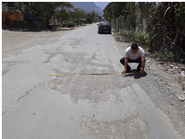
Figura 27: Hundimiento en la carpeta de rodadura Nota: Elaboración Propia
