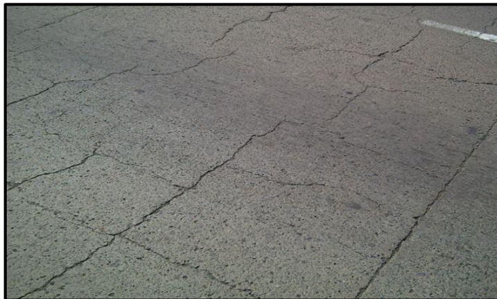
Figura 08: Falla Agrietamiento en Bloque
