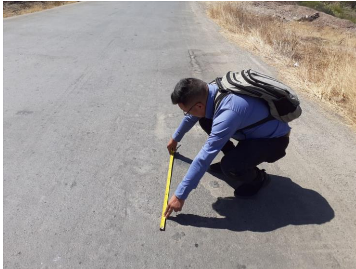
Figura 26: Desgaste leve en el pavimento Fuente: Elaboración Propia
