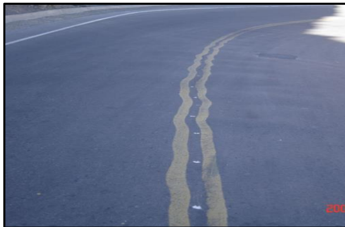
Figura 10: Falla de Corrugación
