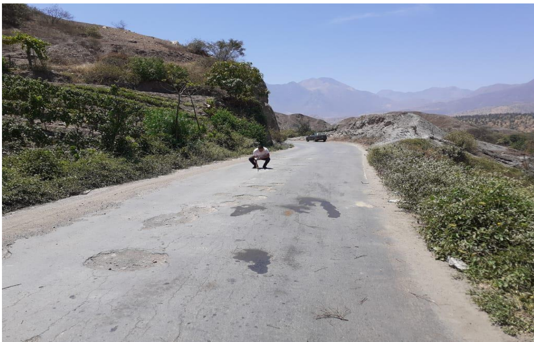
Figura 33: Medida de fallas en el pavimento de la carretera desvió cascás – baños chimú Fuente: elaboración Propia
