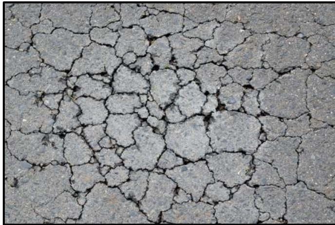
Figura 06. Falla Piel de Cocodrilo
