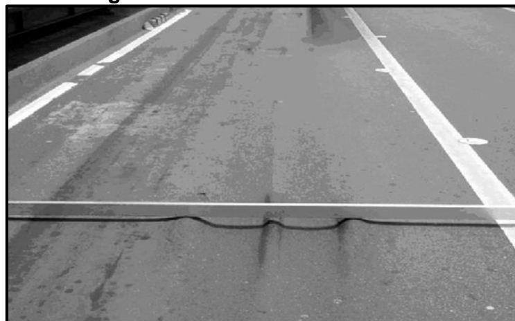
Figura 20: Falla de Ahuellamiento
