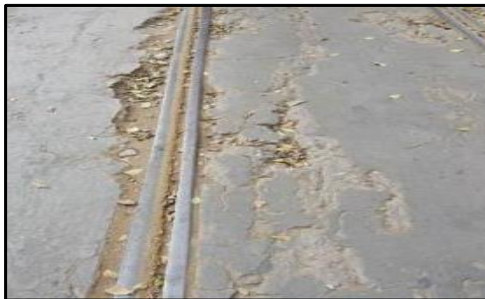
Figura 19: Falla de Cruce de Vía Férrea
