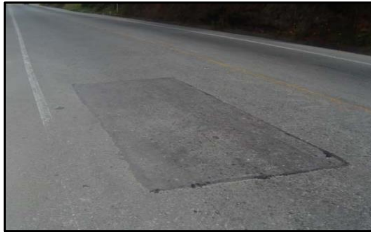
Figura 16: Falla de Parcheo y Acometida
