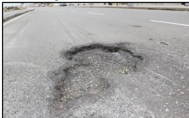
Figura 19: Falla de Hueco
