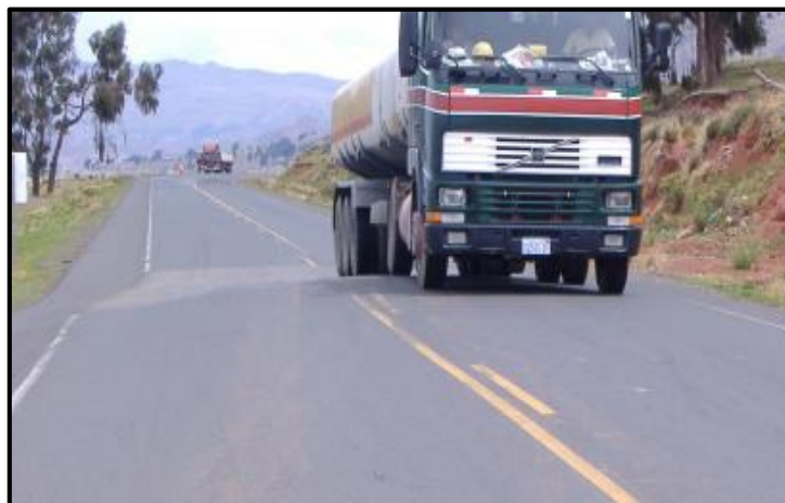
Figura 23: Falla de Hinchamiento
