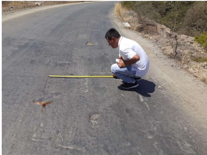
Figura 29: Daño superficial del pavimento. Fuente: Elaboración Propia
