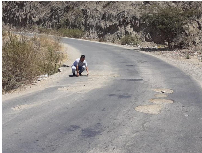
Figura 31: Daño Superficial de la carretera desvió cascás – baños Chimú Fuente: Elaboración Propia
