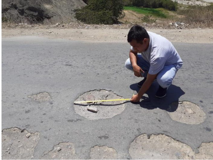
Figura 28: Huevo severo en la carpeta de rodadura en la carretera Desvió Cascas - Baños Chimú. Fuente: Elaboración Propia
