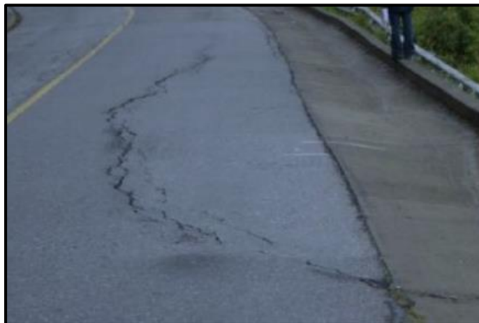
Figura 11: Falla de Depresión
