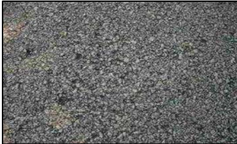
Figura 24: Falla de Desprendimiento de Agregados
