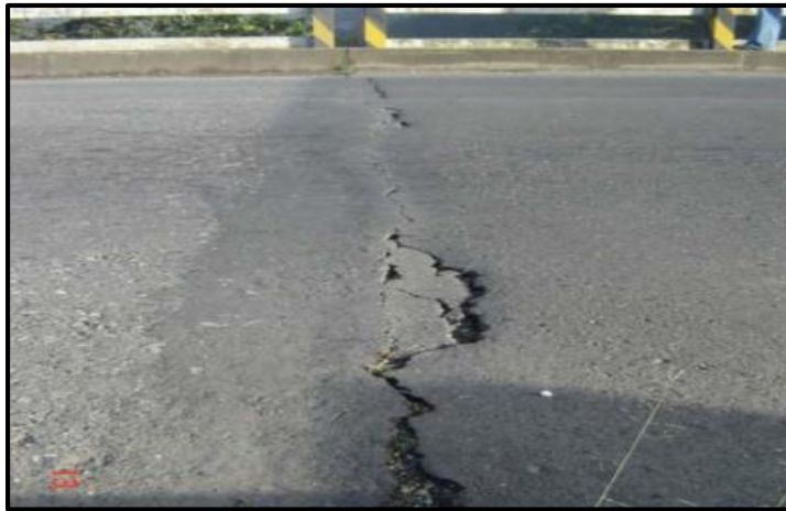
Figura 13: Falla de Grieta de Reflexión
