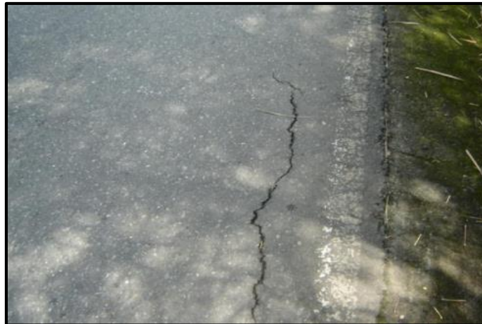
Figura 12: Falla de Grieta de Borde
