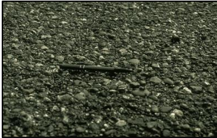
Figura 17: Falla de pulimento de Agregados
