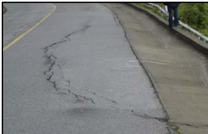
Figura 22: Falla de Grietas Parabólicas
