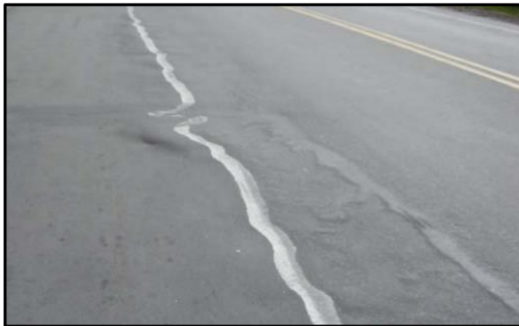
Figura 21: Falla de Desplazamiento
