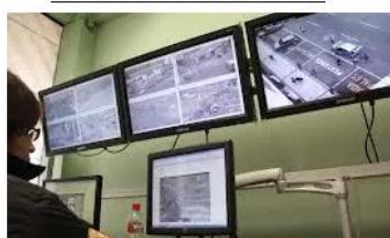
Cámaras de Seguridad
