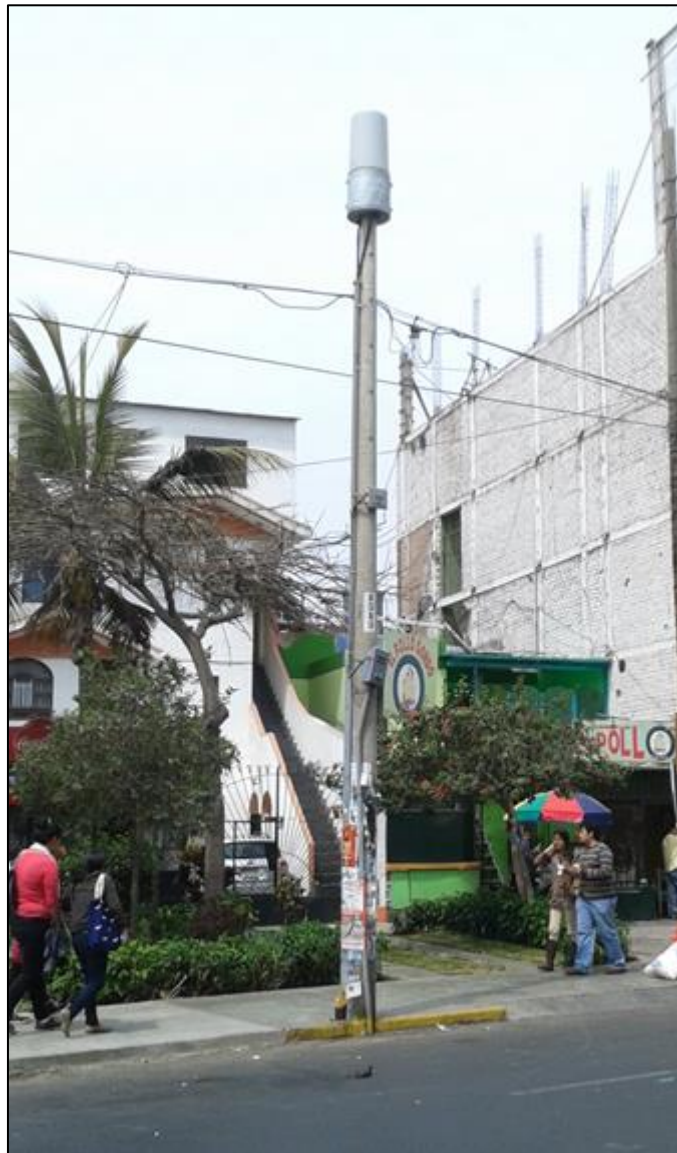
Figura 4.6. Site BTS Mimetizada en Avenida América Sur.
