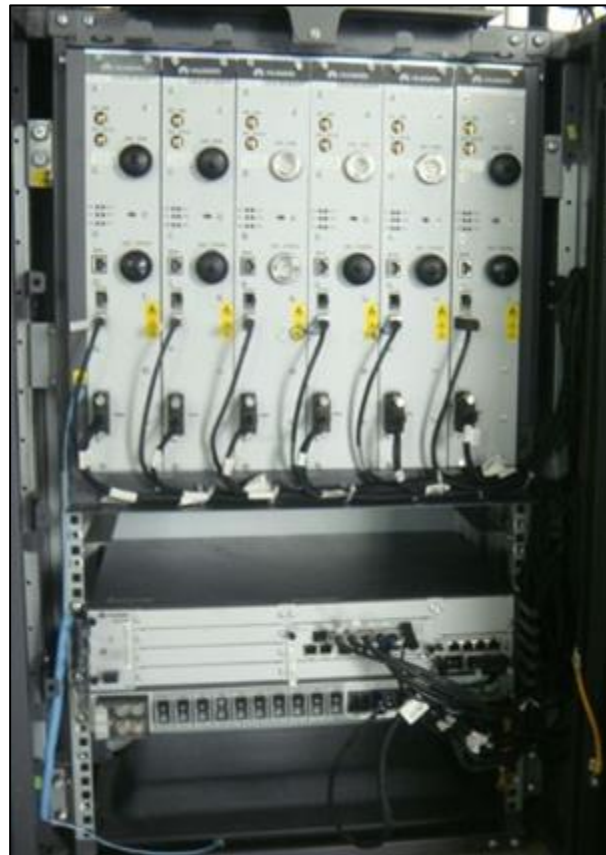
Figura 4.15. Imagen de la BTS3900-Huawei.
