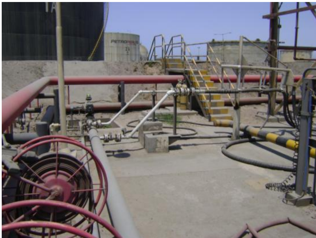
Imagen 34: Ubicación actual de tuberías de GLP líquido y GLP de vapor.
