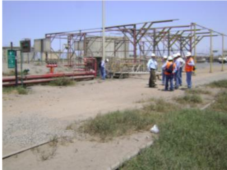
Imagen 33: Zona de ubicación del SKID.
