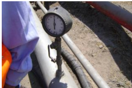
Imagen 29: Manómetro instalado en líneas de despacho de GLP en Vopak Perú S.A.
