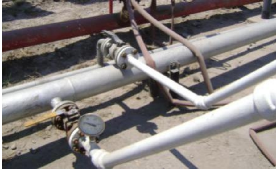
Imagen 44: Tomas de ingreso al SKID Línea de GLP líquido y Vapor
