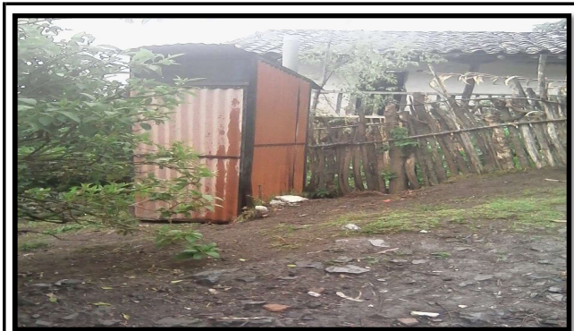
DESCRIPCIÓN FOTO Casetas de UBS existente en mal Estado 3
