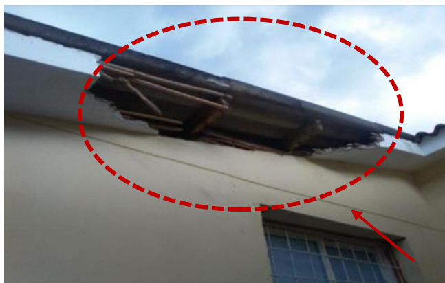
Ilustración 18 Techos en mal estado en los módulos de vivienda
