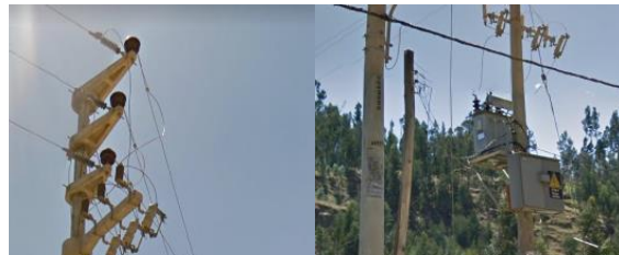
Ilustración 28 Sub estación eléctrica
