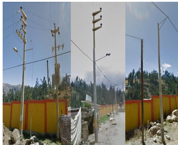
Ilustración 27 Postes de electrificación
