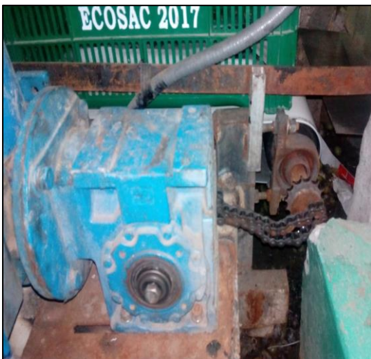
Gráfico 14. Motor en mal estado
