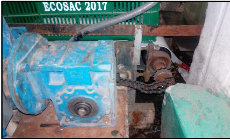
(Motor de faja transportadora en mal estado)
