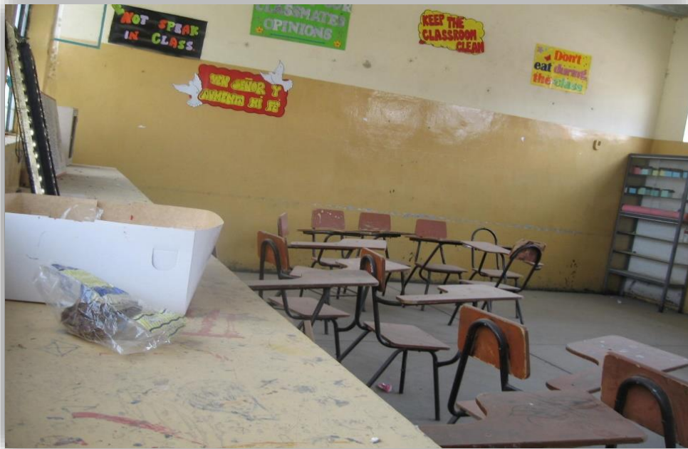
Imagen No. 33 Deterioro de aulas
