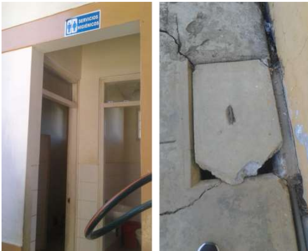
FIGURA 10 Izquierda, únicos servicios higiénicos en funcionamiento, derecha, buzones de desagüe en mal estado
