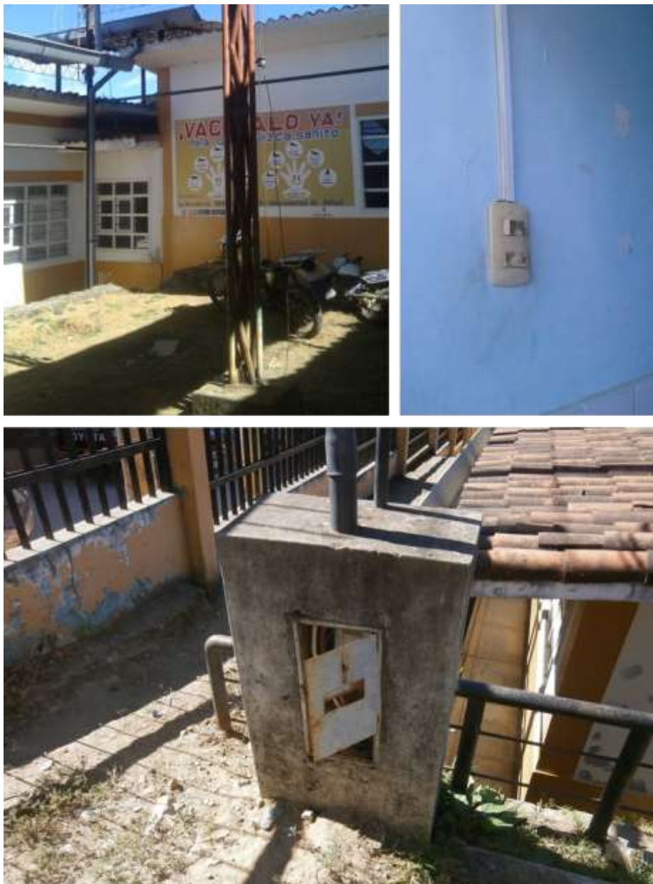
FIGURA 12 elementos del suministro eléctrico sin uso o deteriorados
