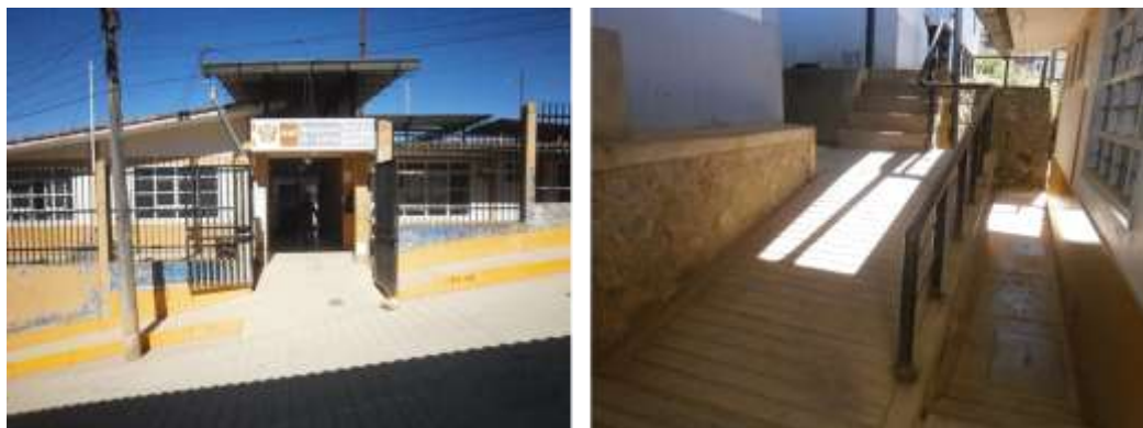
FIGURA 7 izquierda, Ingreso del centro de salud, derecha acceso de rampa interrumpido por escalera para acceder del consultorio a al pabellón secundario
