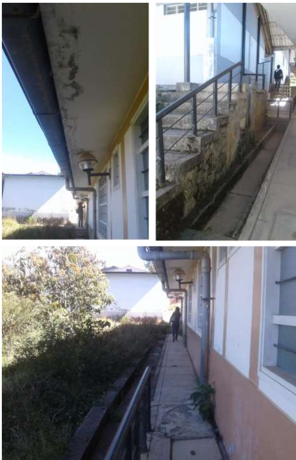
FIGURA 11 canaletas sin rejilla en el suelo, techos deteriorados por la humedad
