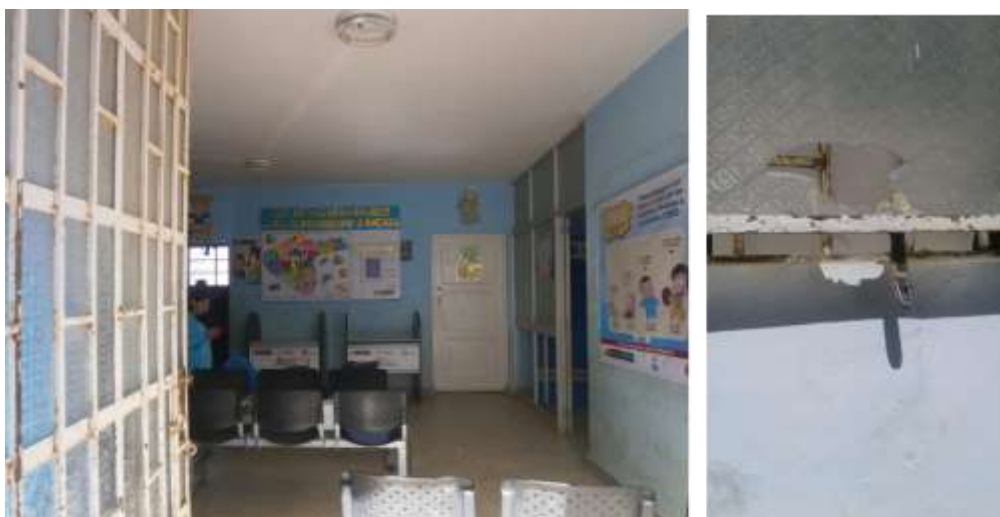
FIGURA 8 estado de las puertas y ventanas del establecimiento.
