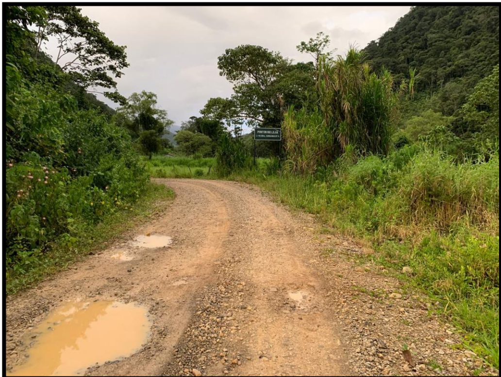
Fotografía 1: mal estado de la carpeta de rodadura.
