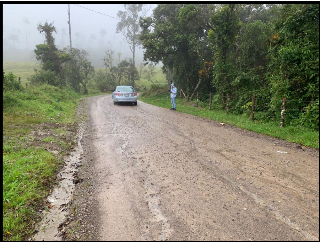
Fotografía 3: Pendiente de bombeo ineficiente.
