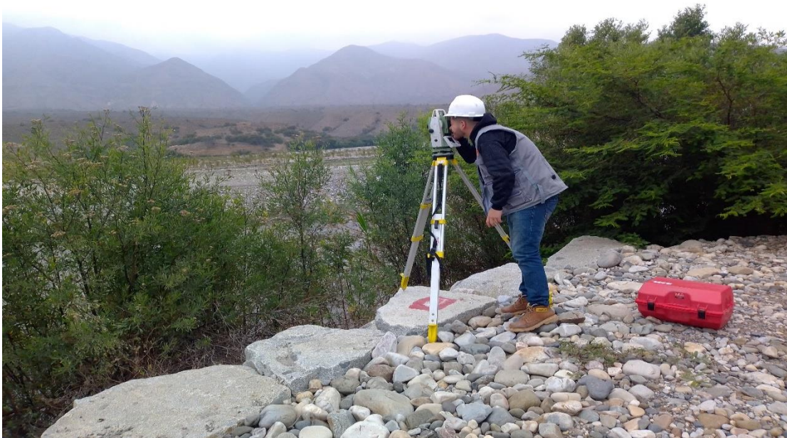
Fotografía 2: Se aprecia en la imagen el levantamiento topográfico en la corona del dique existente margen derecho aguas abajo.
