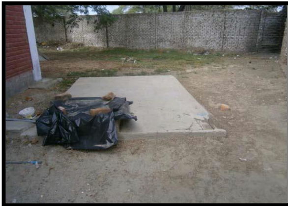
Cisterna de Agua en Mal Estado
