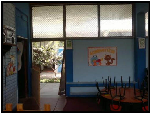
Puertas de Pabellón de Aula No Cumplen con la Norma
