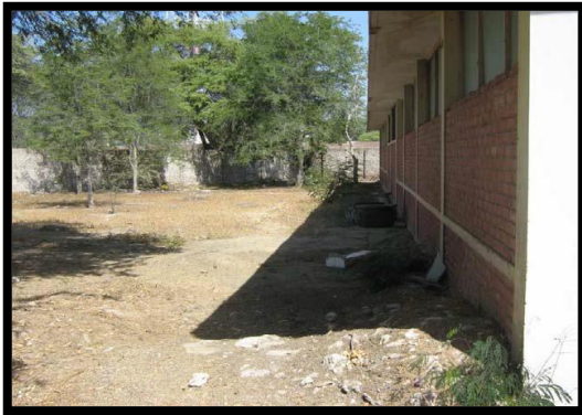
Pabellones de Aula sin veredas de Protección
