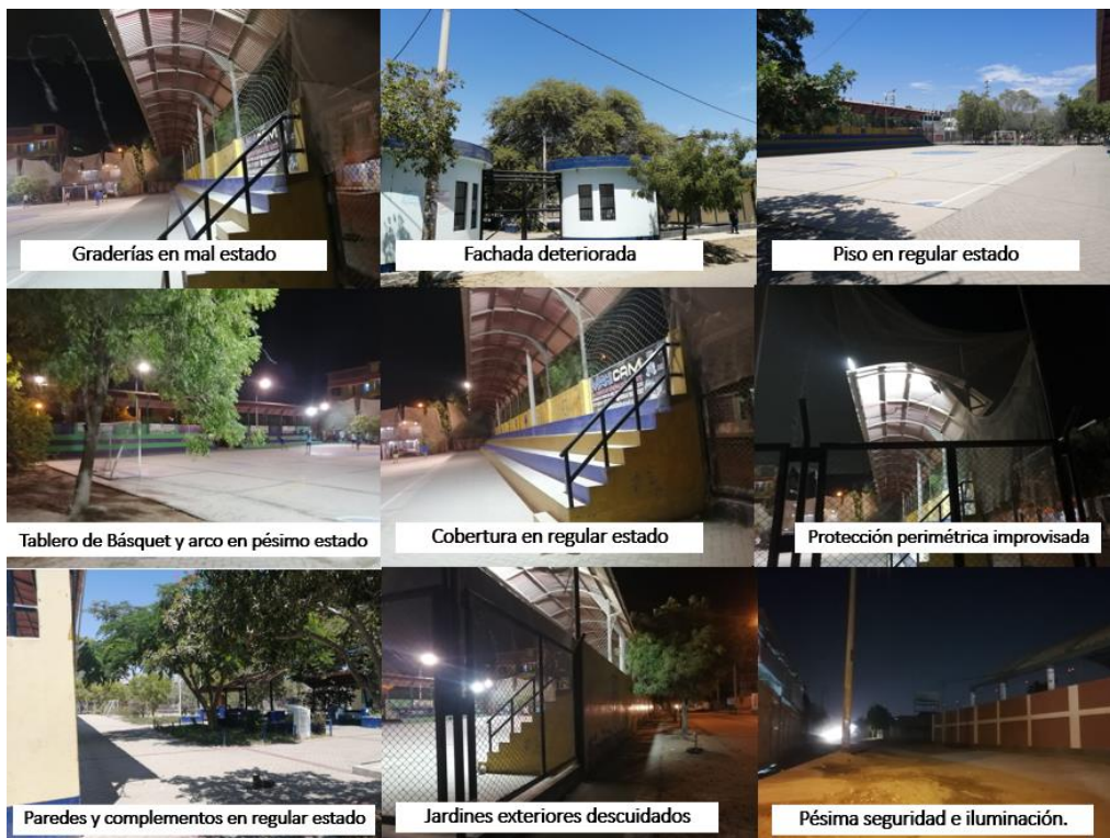
Imagen 13. Evidencia del estado de la Infraestructura del Coliseo San Ramón.
