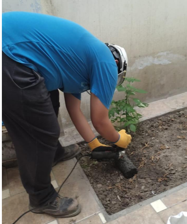
Descripción: Corte de probetas de concreto para ensayos de permeabilidad con amoladora
