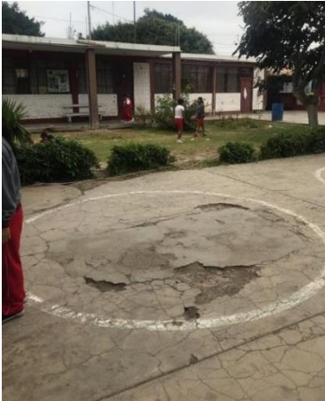
Imagen 23: Losa de patio de la I.E. N° 81585
