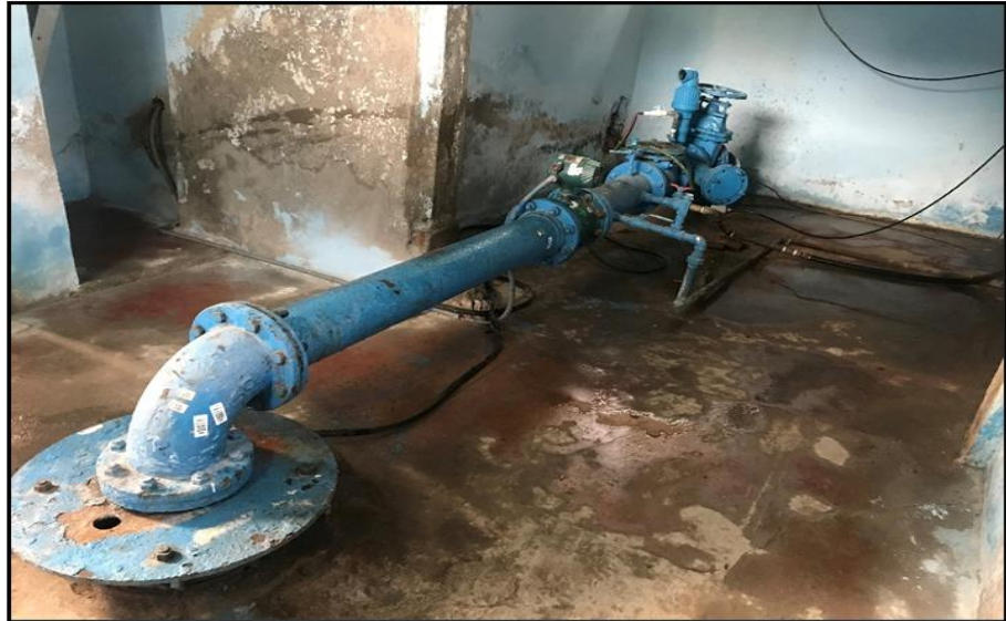
Figura 23. Pozo Arboleda II
