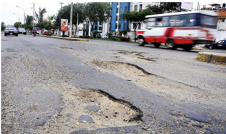
Pérdida de agregados
