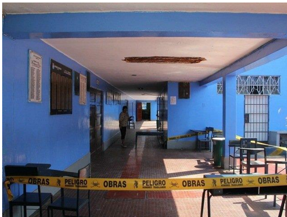
Fotografía N° 05 Vistas de infraestructura declarada en riesgo de la I.E. N° 81011 Antonio Raimondi
