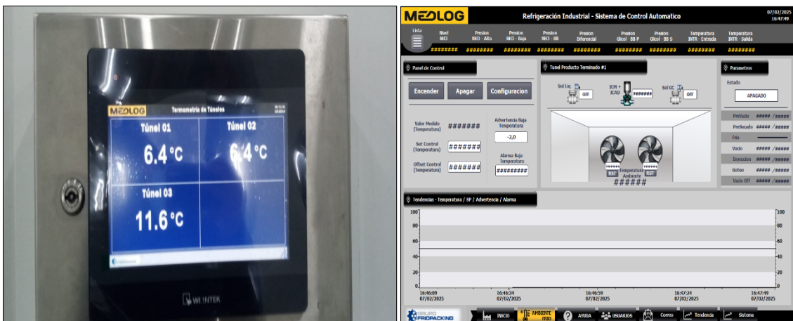
Evidencia 17 Cámaras encendidas y enfriando.
