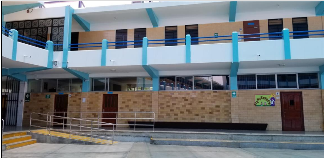
FIGURA 17: No existen planos a desnivel y la deformidad en la losa es imperceptible, por lo tanto, se puede despreciar.
