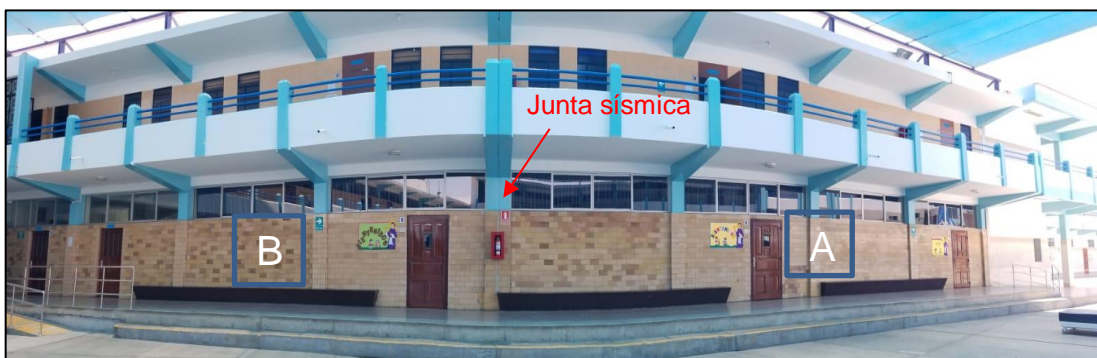
FIGURA 27: Bloques “A”, “B” y junta sísmica del ala izquierda del pabellón “U”.
