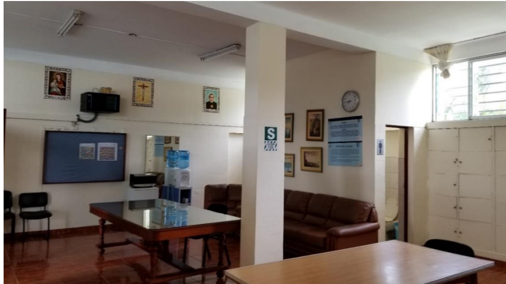
FIGURA 13: Interior del salón de profesores del bloque “B”, presenta mampostería uniforme y en un buen estado.
