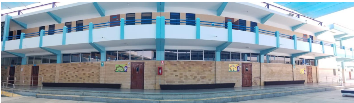
FIGURA 24: Elementos no estructurales muy bien conectados a la estructura.
