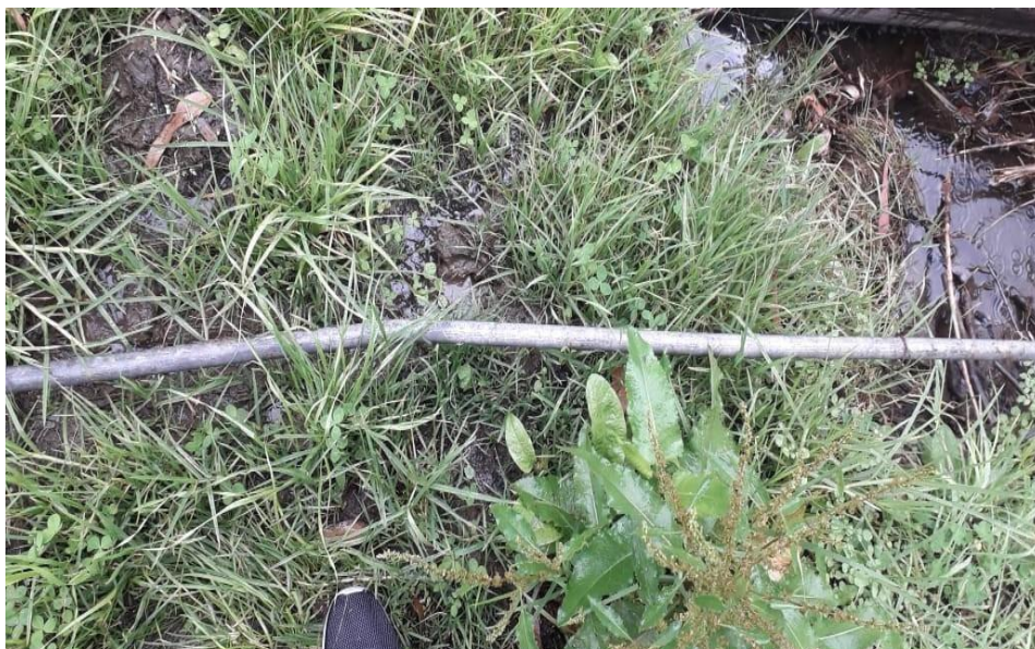
Fotografía 6 Tubería de distribución expuesta y en condiciones precarias
