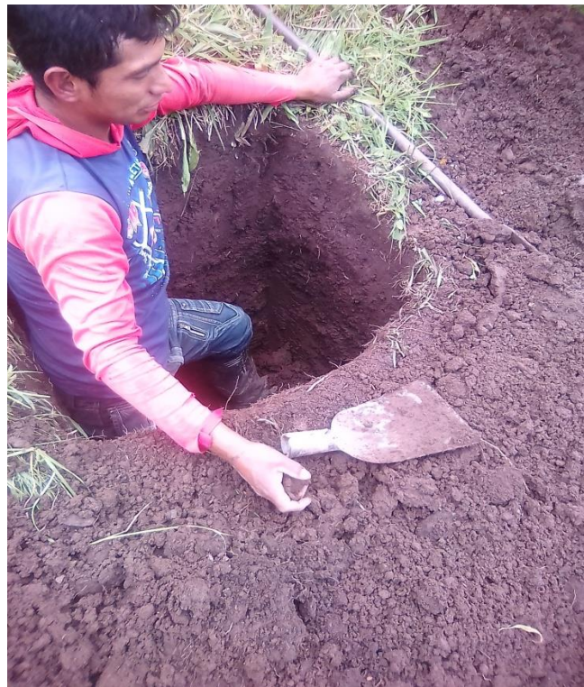
FOTO 18. VALVULA DE CONTROL Y CALICATA
