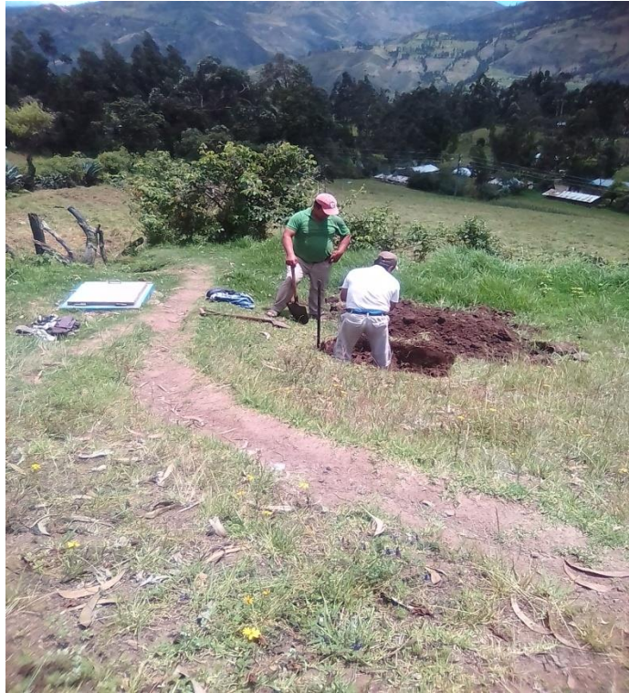
FOTO 17. VALVULA DE CONTROL Y CALICATA
