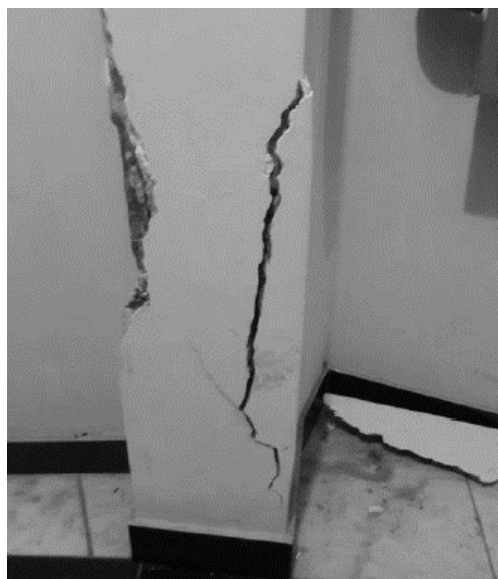
Figura N°48: Estado de columnas en Teatro Municipal de Trujillo
