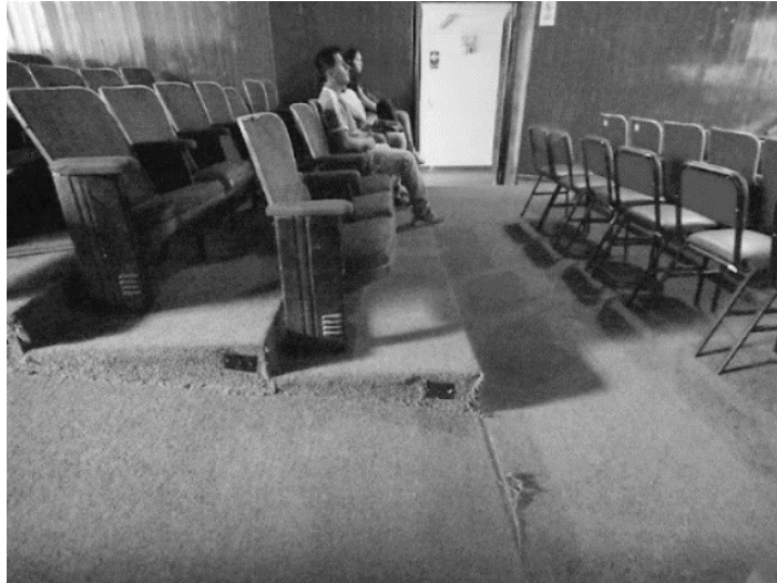
Figura N°47: Teatrín Virgilio Rodríguez Nache con alfombra deteriorada, butacas deterioradas y sillas no adecuadas para el teatrín
