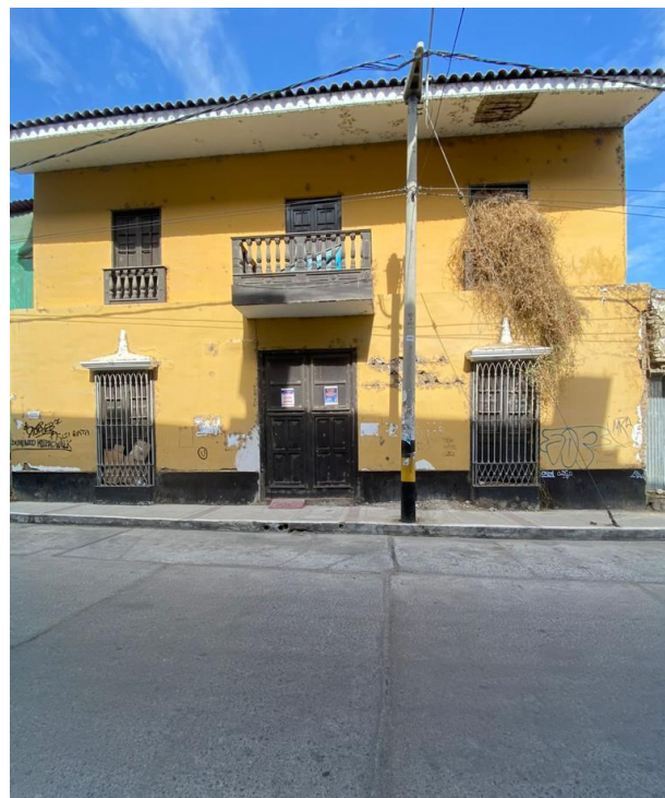
Ilustración 13: Fachada peligro en derrumbe
