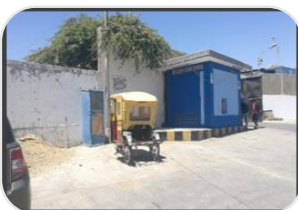
Sub estación eléctrica • Caceta de vigilancia y sub estación eléctrica al ingreso y al frente de zona de lavado
