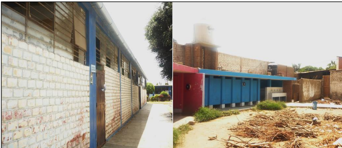
Figura 8: Estado Actual del P-04 y SS.HH.
