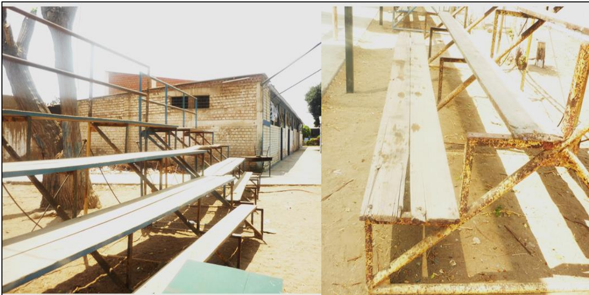
Figura 11: Estado Actual de las Graderías Metálicas
